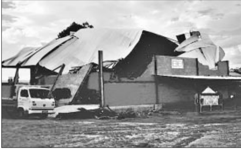
Estragos: unidade que recebe grãos teve parede derrubada sobre caminhão
