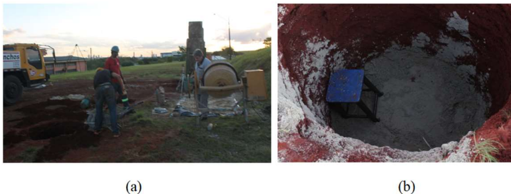
Figura 3.22: Execução da mistura (a) detalhe dos materiais utilizados na dosagem e lançamento na cratera; (b) espalhamento na base da cratera
