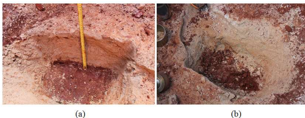
Figura 4.34: Camada após execução do ensaio, sem ocorrência de fissuras
