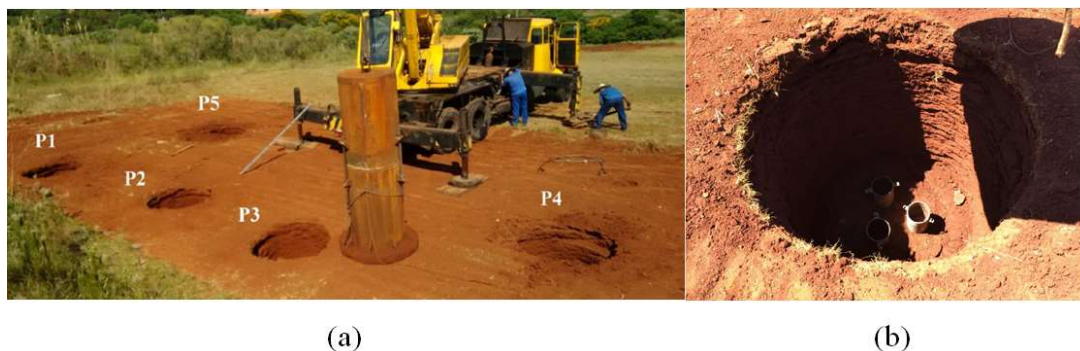
Figura 4.2: Crateras obtidas por Rizzon (2016): (a) vista geral do campo após as compactações (b) detalhe do cilindro formado no solo
