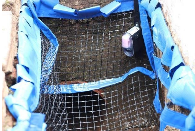
Figura 14 - Modelo filtro retentor de resíduos da Net Sensors instalado em São Paulo.
