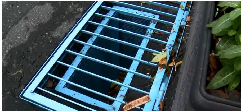
Figura 16 - Boca de lobo instalada em Blumenau, Santa Catarina.
