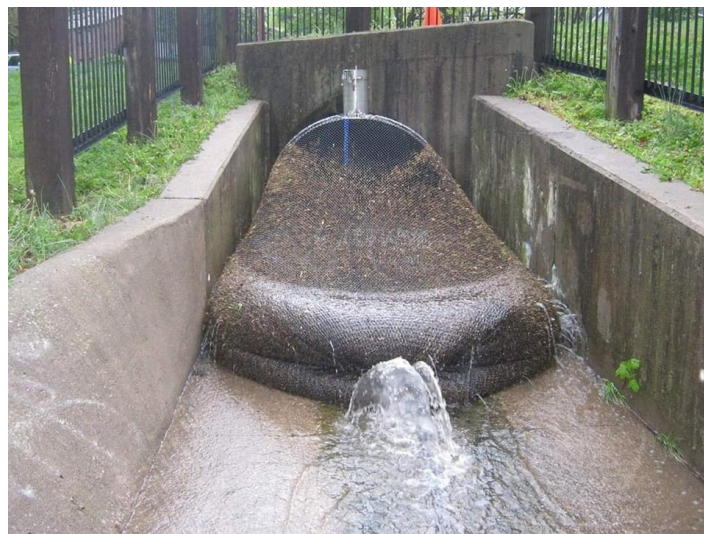
Figura 22 - Rede retentora de resíduos.
