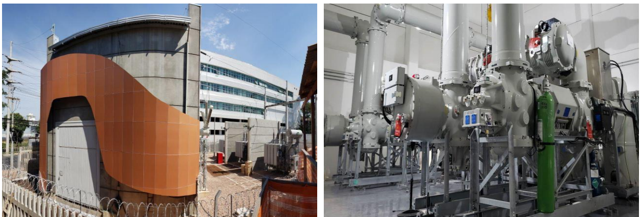
Figura 3 - Subestação GIS semi-abrigada em Porto Alegre - SE 69/13,8 kV - 3x 15/20 MVA Imagem da esquerda vista panorâmica da SE e imagem da direita vista interna da casa GIS.
