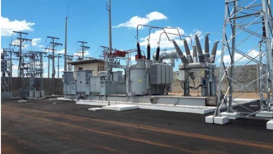
Figura 2 - Subestação Serra do Salitre da CEMIG - SE 138/13,8 kV - 15 MVA.
