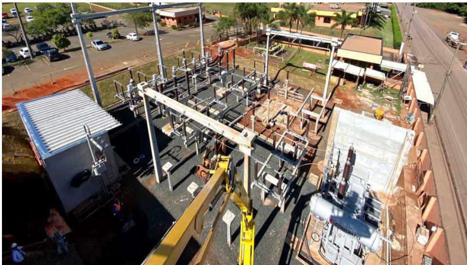
Figura 1 - Subestação convencional em Cordeirópolis/SP - SE 138/13,8 kV - 10/12,5 MVA.
