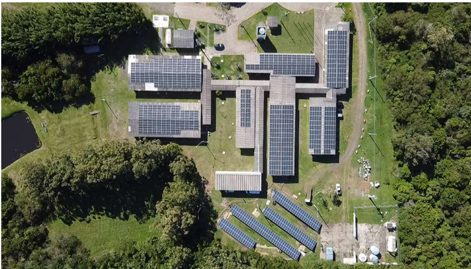
Vista aérea da usina fotovoltaica com 996 módulos instalada em uma área de 744m 2 no Câmpus Litoral Norte
