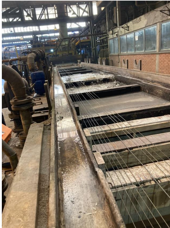
Imagem 3 - Processo de Enchimento do Tanque de Decapagem Ácida.
