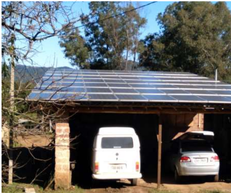
Figura 5 - Imagem mostrando os painéis solares instalados
