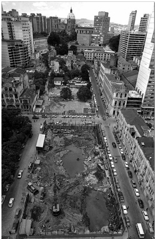
Figura 184- Imagem do entorno em 1976. Na área em obras, em primeiro plano, hoje está o atual prédio da Caixa Econômica Federal. Na área vazia ao fundo localizava-se o Antigo Grande Hotel.
