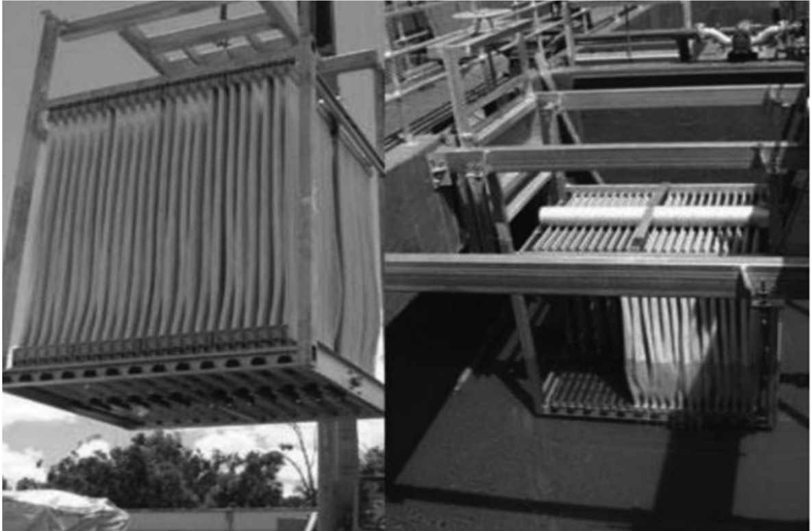
Figura 13: Rack contendo diversos módulos de membranas para sistemas MBR
