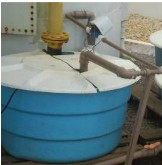
Figura 4.11 Entrada através de bomba submersa instalada em caixa d'água.
