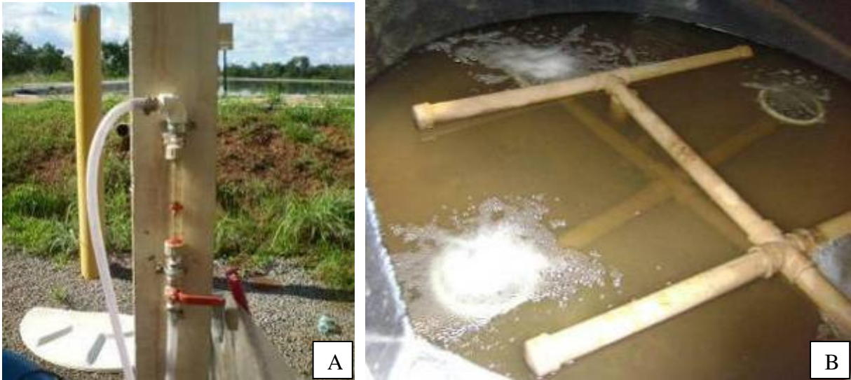
Figura 4.7 A: Medidor de vazão de ar (rotâmetro) e B: Difusores de ar de membrana.
