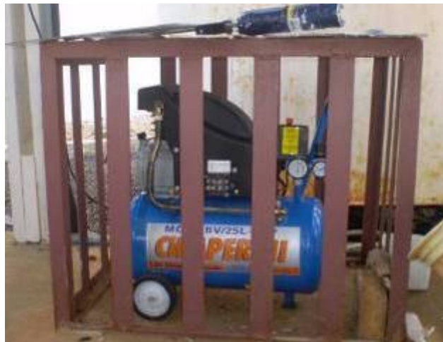
Figura 4.6 Sistema de aeração.
