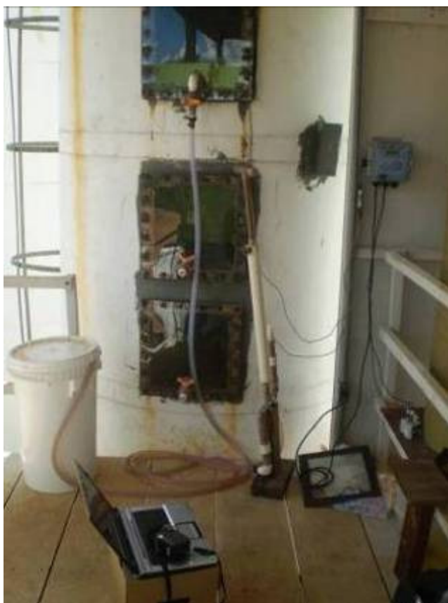
Figura 4.10 Instalação para injeção do traçador, mostrando as janelas do reator UASB e equipamentos associados
