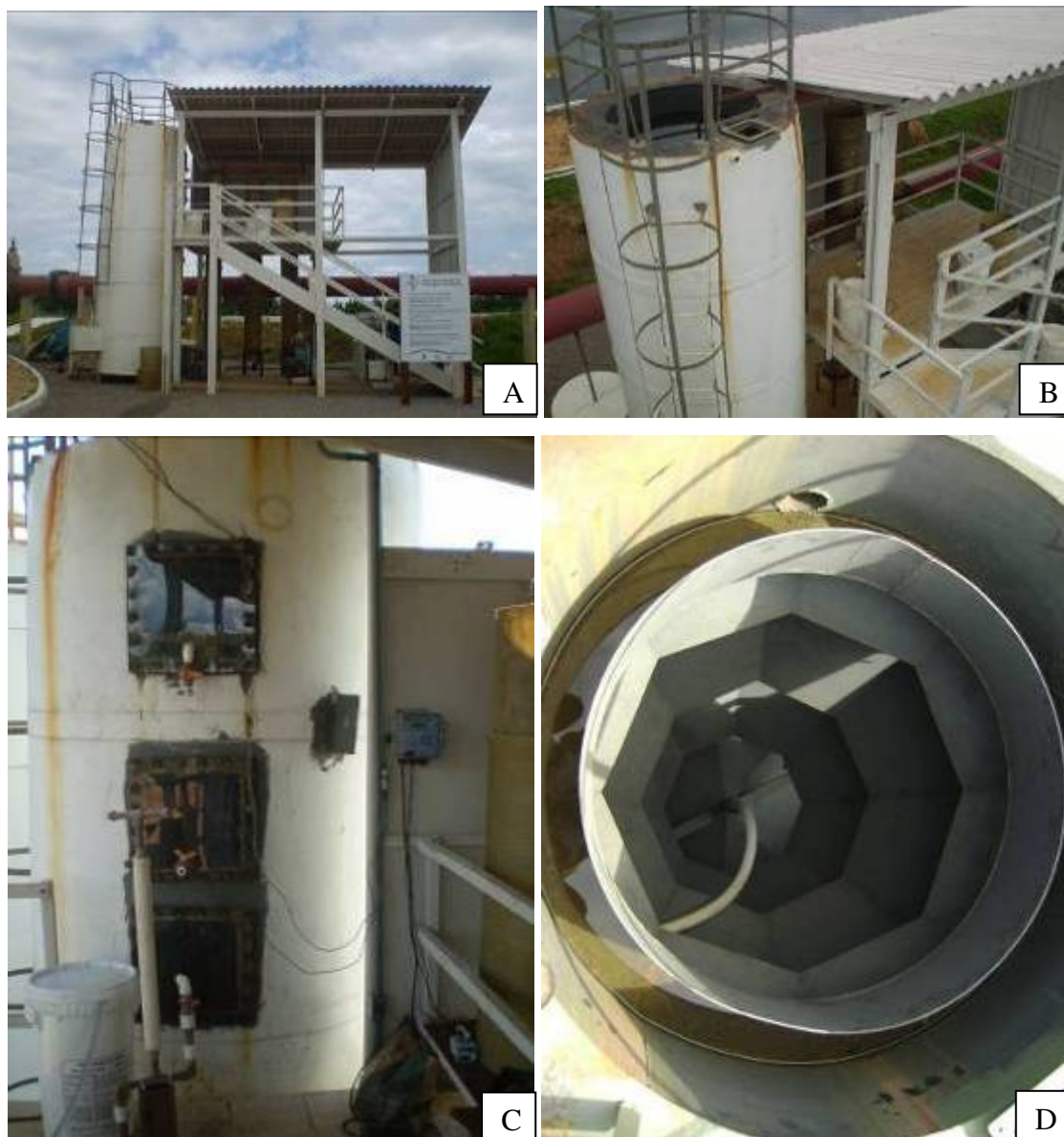
Figura 4.3 Fotos do protótipo de reator UASB instalado na ETE Vila União, Palmas, TO. A: área experimental; B: vista frontal; C: vista lateral; D: vista superior.
