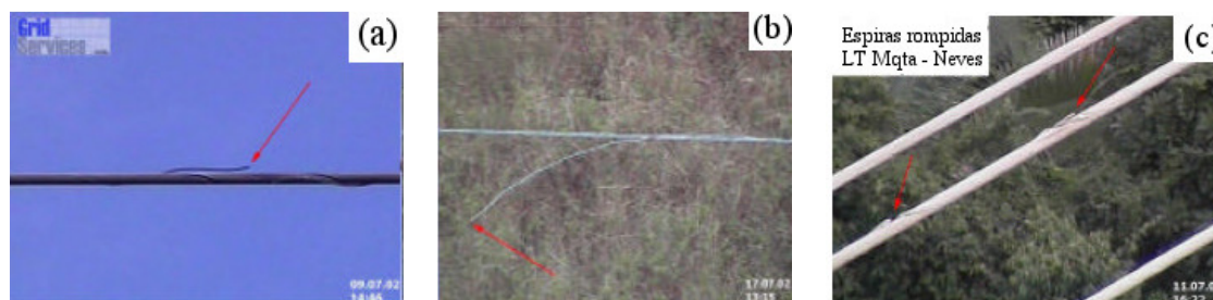
Figura 3.1: Cabos danificados – Espiras rompidas: (a) LT Gafanhoto – Divinópolis 2; (b) LT Ipanema – Caratinga; (c) LT Mesquita – Neves (Mourão, 2005).
