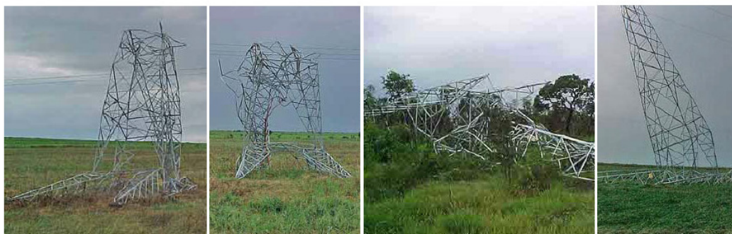
Figura 2.4: Colapso das torres 94, 95, 96 e 108 da LT PCH Paraíso / Chapadão do Sul (Soares, 2007).
