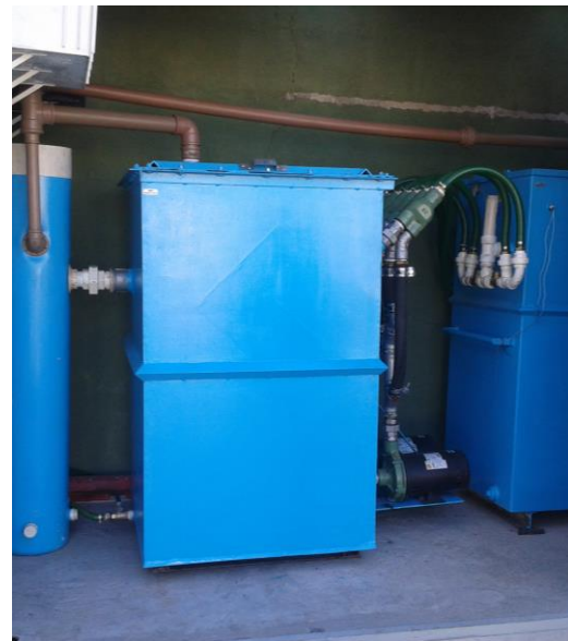
Figura 65: Equipamento a ser comercializado, instalado em uma área contaminada.
