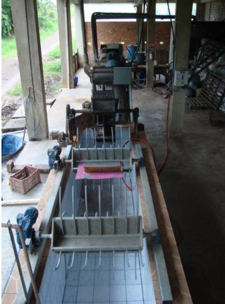
Figura 4.20: Planta nova instalada na cooperativa
