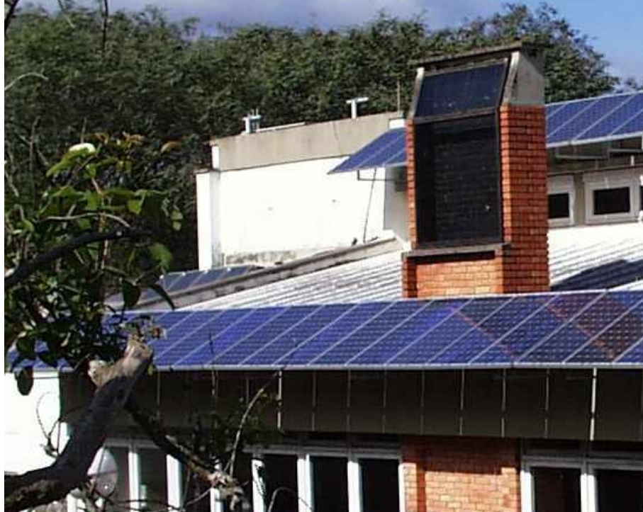
Figura E1. Sistema fotovoltaico do laboratório.
