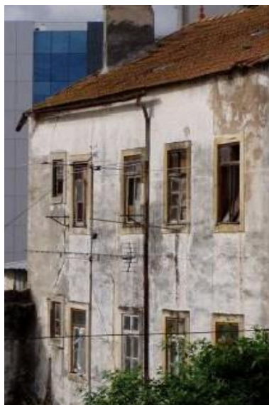
Figura 26: Edificações mal conservadas, Coimbra – Portugal (Viva Coimbra, 2007)
