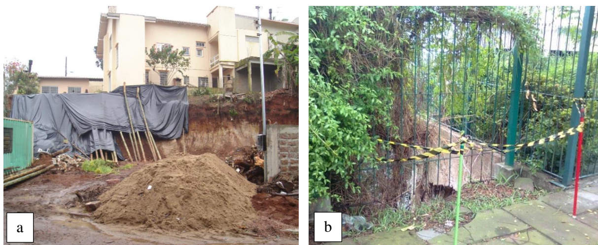
Figura 41: Escorregamentos em áreas de ocupação regular em Porto Alegre (a) Rua Professor Antônio José Remião, bairro Espírito Santo no ano de 2008; (b) Rua Engenheiro Álvaro Nunes Pereira, bairro Moinhos de Vento no ano de 2013 (imagens cedidas pelo PAR, 2013).
