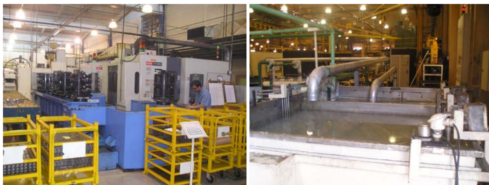
Figura 24. Tanques de máquinas e lavadoras.
