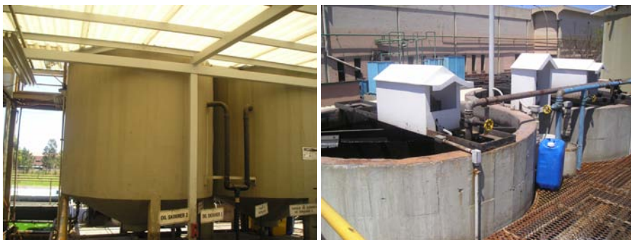
Figura 17. Tanque de quebra de emulsão.
