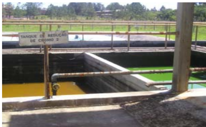
Figura 18. Tanques de redução do cromo.
