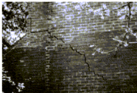
Figura 49: fissura por recalque de fundação em um canto da edificação (BRICK INDUSTRY ASSOCIATION, 1991)
