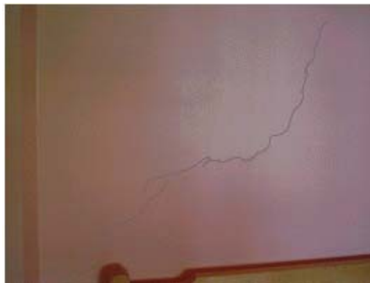
Figura 20: fissura inclinada em parede transversal por movimentação térmica da laje de cobertura (fonte: arquivo pessoal do autor)
