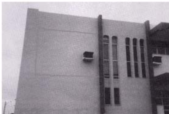
Figura 24: fissuras de destacamento por movimentação térmica da estrutura de concreto armado (THOMAZ, 1989)
