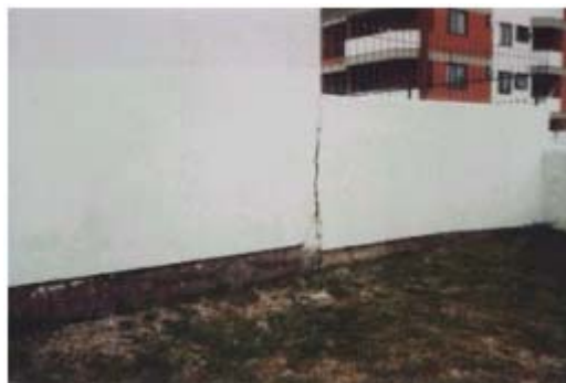
Figura 58: fissura vertical entre o muro e a edificação por deficiência de amarração (fonte: arquivo de fotos do NORIE/UFRGS)
