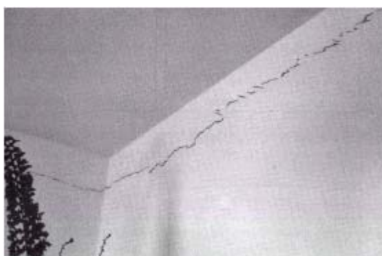
Figura 15: fissura horizontal com componentes inclinados (escamas) por movimentação da laje de cobertura (THOMAZ, 1989)
