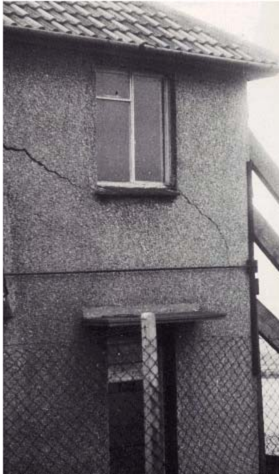
Figura 48: fissuras por recalque de fundações (ELDRIDGE, 1982)
