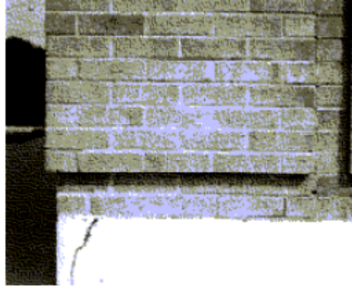
Figura 31: fissura na base da parede e na interface por retração da viga de apoio (BRICK INDUSTRY ASSOCIATION, 1991)
