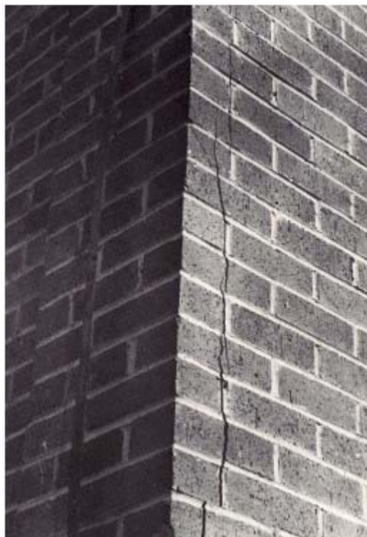
Figura 37: fissura vertical no canto do prédio por expansão da alvenaria (ELDRIDGE, 1982)
