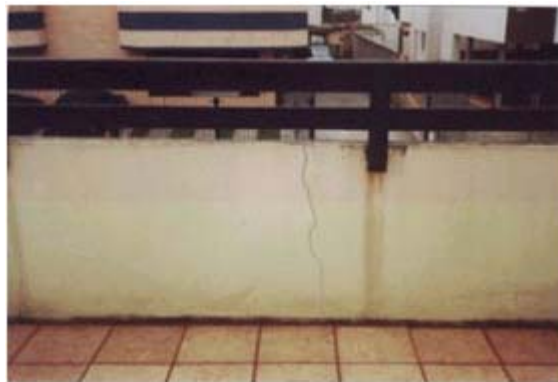
Figura 26: fissura vertical por movimentação térmica da alvenaria em mureta de terraço (fonte: arquivo de fotos do NORIE/UFRGS)
