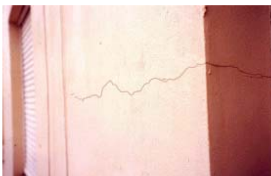
Figura 16: fissura horizontal na parede de fachada por movimentação térmica da laje (fonte: arquivo pessoal do autor)
