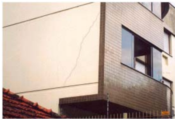
Figura 43: fissura inclinada em parede por deformação do balanço (fonte: arquivo pessoal do autor)
