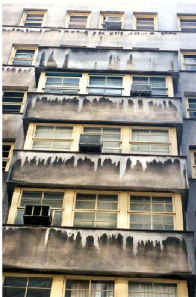
Figura 17: manchamento por contaminação atmosférica com parapeitos lavados irregularmente pela ação da água da chuva escorrida (PETRUCCI, 2000)
