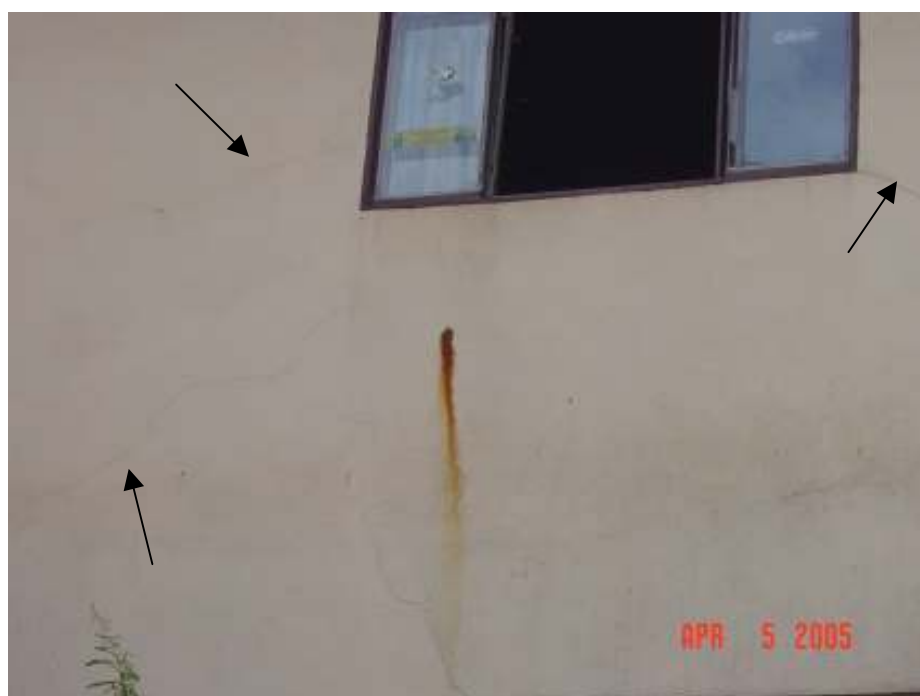
Figura 34: incidência de vesícula no revestimento, percebendo-se também a presença de fissuras disseminadas nesse plano de fachada.
