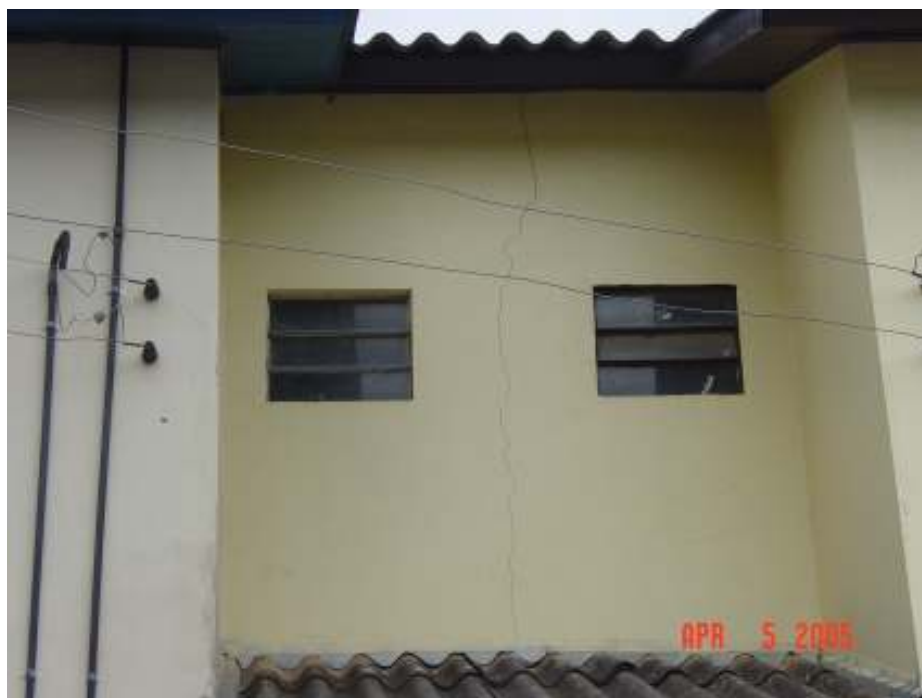
Figura 29: configuração típica de fissura incidente na parede comum entre dois sobrados geminados
