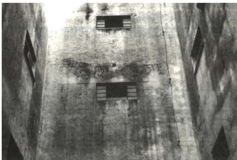
Figura 15: revestimento em argamassa, com manchas de umidade, em adiantado processo de degeneração (THOMAZ, 1989)
