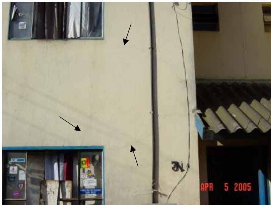
Figura 27: configuração típica da incidência de fissuras disseminadas nos planos de fachada dos sobrados
