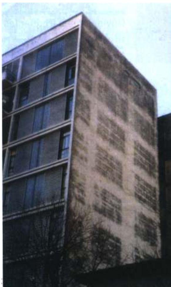
Figura 16: incidência de espectro de juntas ou “fantasmas” em fachada de edificação (LEAL, 2003b)
