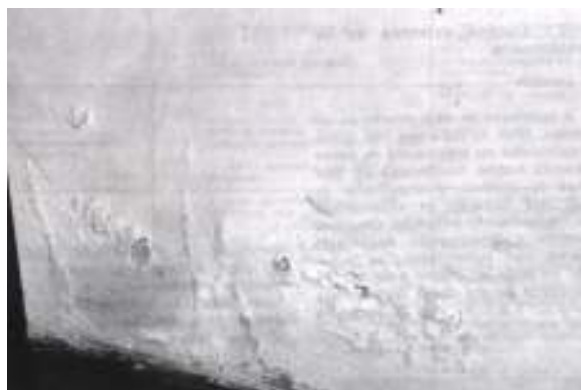
Figura 6: descolamento com empolamento da argamassa de revestimento, efeito da umidade sobre o reboco (CINCOTTO, 1988)
