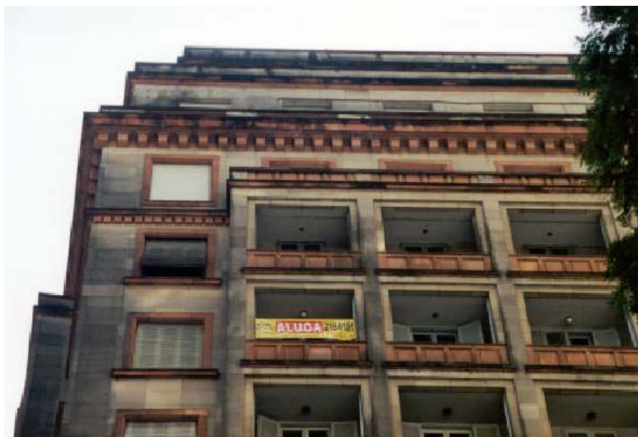
Figura 18: fachada sul com acentuado manchamento em função da baixa evaporação de umidade que estimula a adesão de contaminantes atmosféricos (PETRUCCI, 2000)
