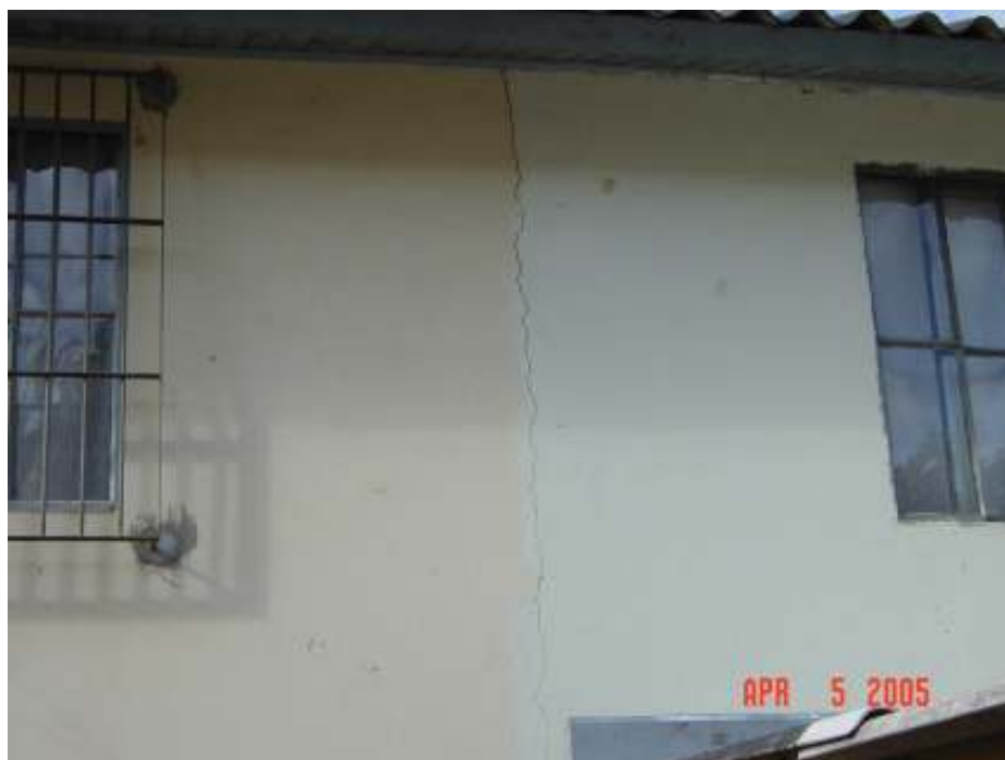
Figura 30: fissura na parede comum entre módulos de dois sobrados
