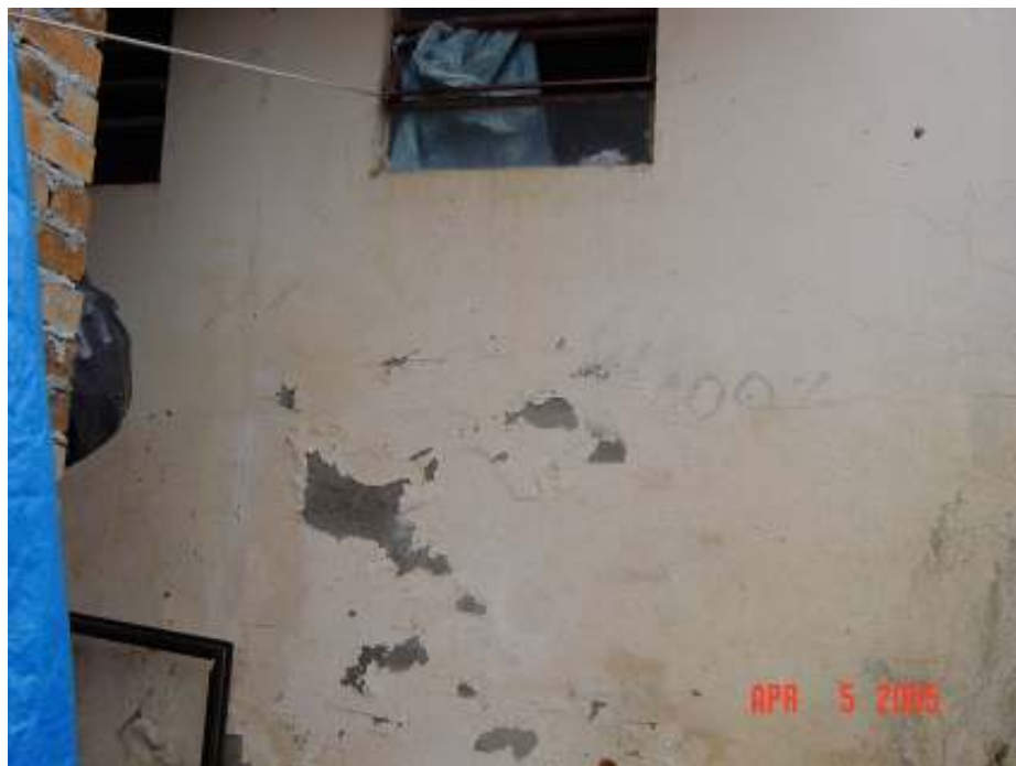
Figura 33: superfície do revestimento com manchas de umidade de infiltrações e empolamento da pintura
