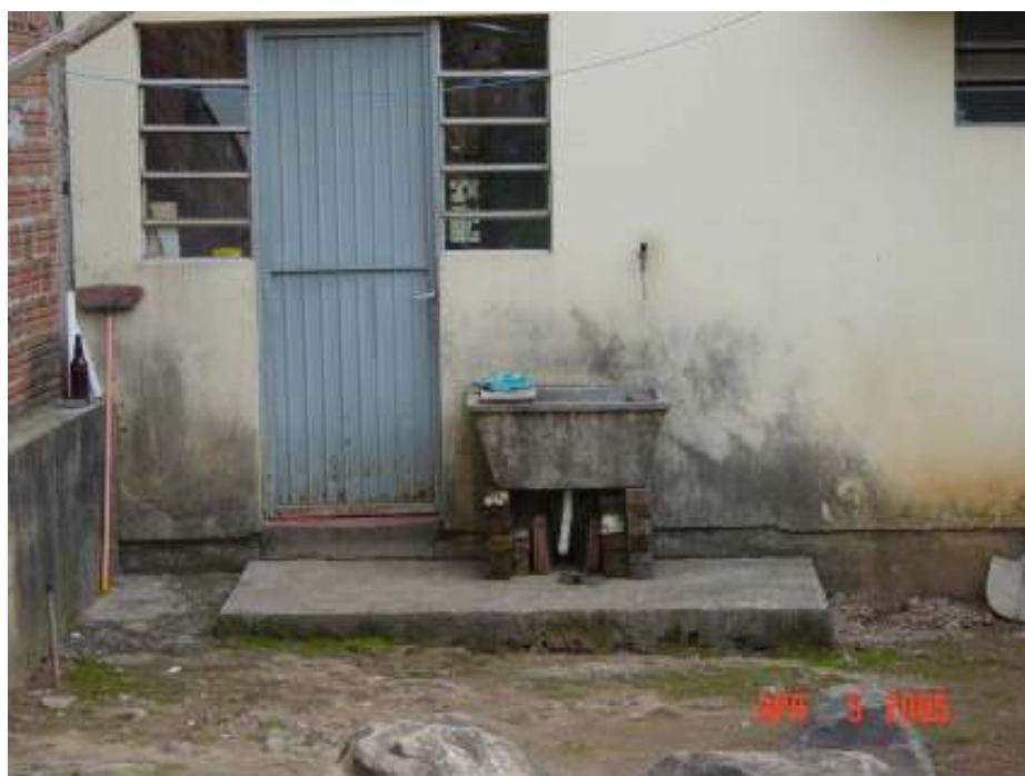
Figura 32: manchas de umidade no revestimento decorrentes de respingos das águas das chuvas
