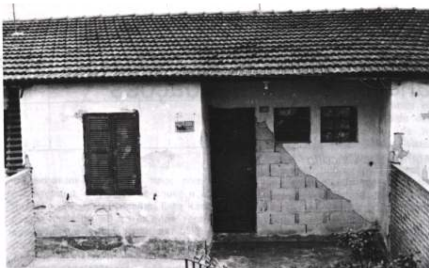
Figura 7: descolamento em placa do revestimento por falta de chapisco (CINCOTTO, 1988)
