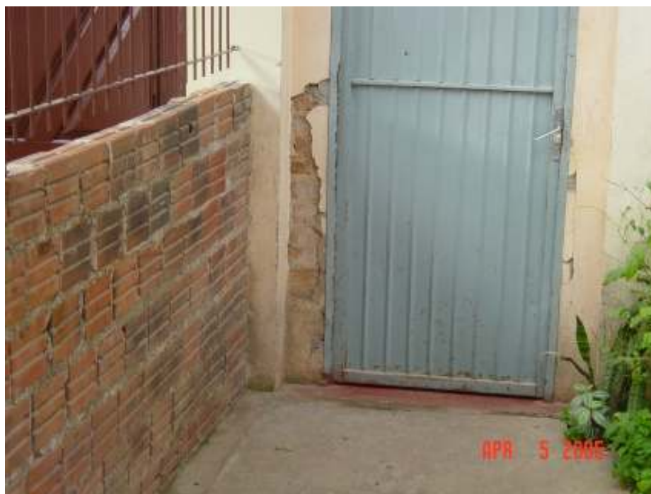
Figura 35: descolamento em placa da argamassa do revestimento no entorno da esquadria
