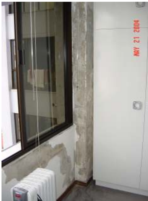
Figura 8: incidência de descolamento com pulverulência em revestimento interno
