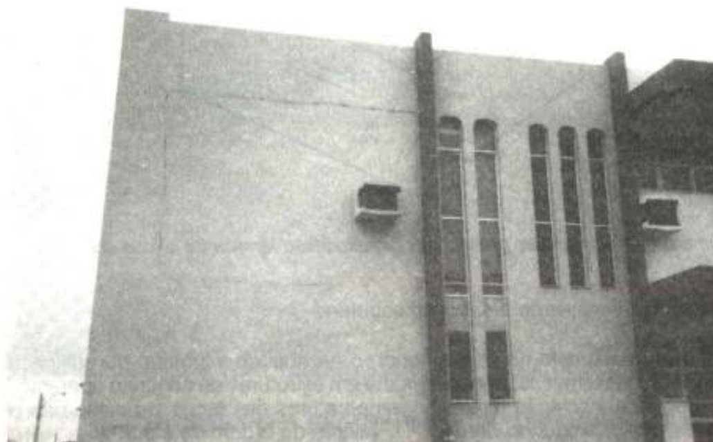
Figura 13: destacamento entre alvenaria e estrutura por movimentações térmicas diferenciadas (THOMAZ, 1989)
