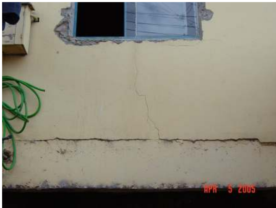
Figura 31: fissura de maior abertura com origem não relacionada ao revestimento
