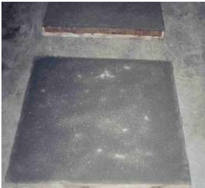
Figura 41: escurecimento da superfície, evidenciando a absorção de umidade pelo material
