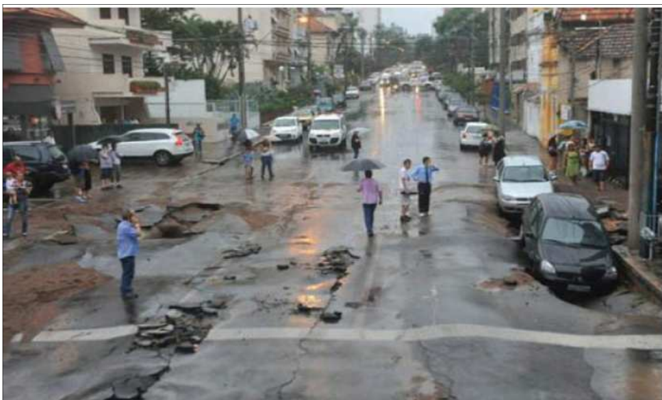
Figura 9: Rompimento do Conduto Forçado Álvaro Chaves.
