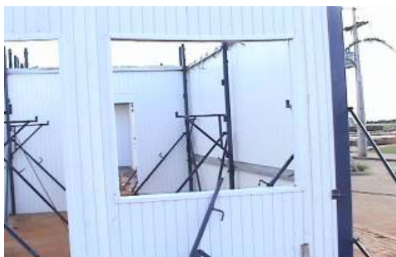
Figura 47: Quadro de espera para esquadrias
