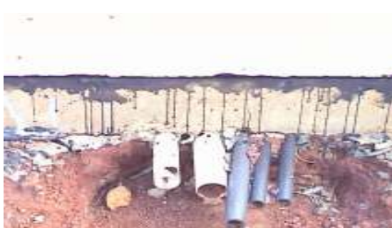
Figura 54: Tubulação de esgotos e eletrodutos
