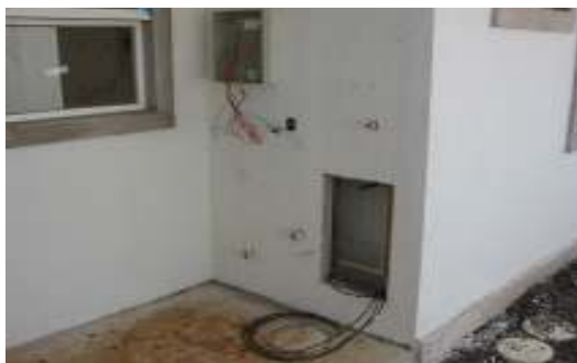
Figura 75: Caixas de distribuição elétrica e telefônica
