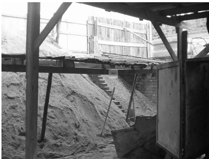
Figura 42: baias de agregados com vista em primeiro plano da carregadeira da betoneira na obra 2.
