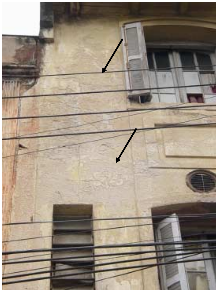
Figura 87: erosão eólica e lavagem da fachada, desgaste do revestimento de argamassa; despigmentação e descolamento da pintura.
