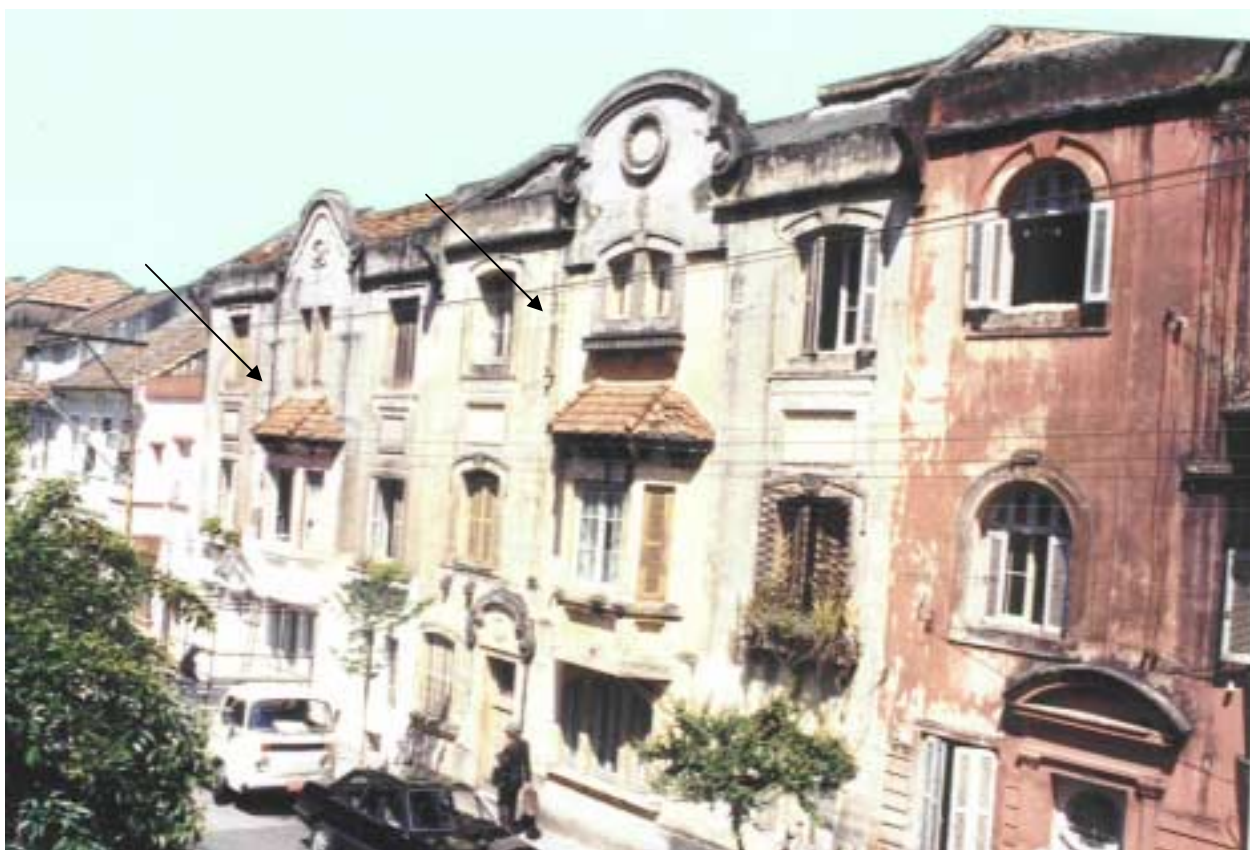
Figura 77: manchas de escoamento devido à condução da água do frontão para a superfície da parede das edificações, registro fotográfico, ano 1989.
