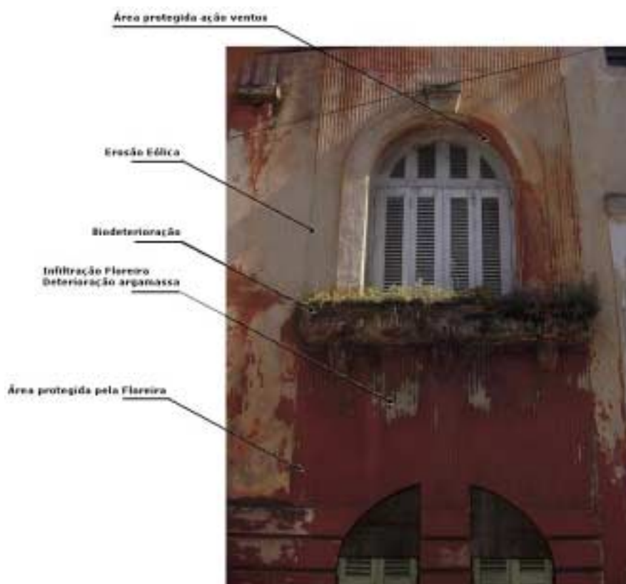
Figura 98: área protegida, área superior à janela com abrasão superficial descolamento e despigmentação pintura, floreira com biodeterioração, área inferior à floreira conservação da pigmentação da pintura e revestimento.
