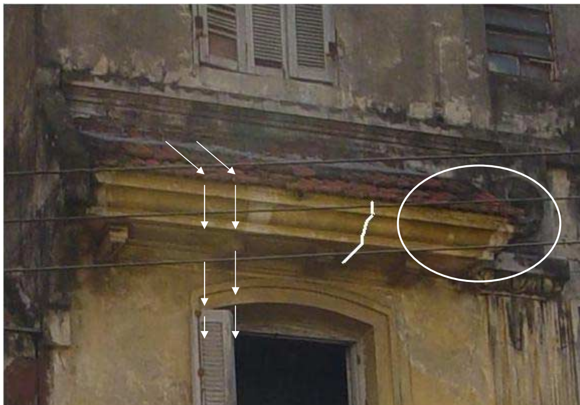
Figura 90: a geometria dos elementos arquitetônicos de fachada determina a trajetória do fluxo da lâmina de água, locais onde a telha está danificada ocorre escoamento de água para o beiral, lavando sua superfície.
