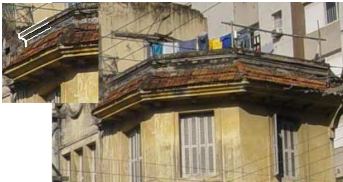
Figura 88: manchamento parapeito da cobertura, edificação A
