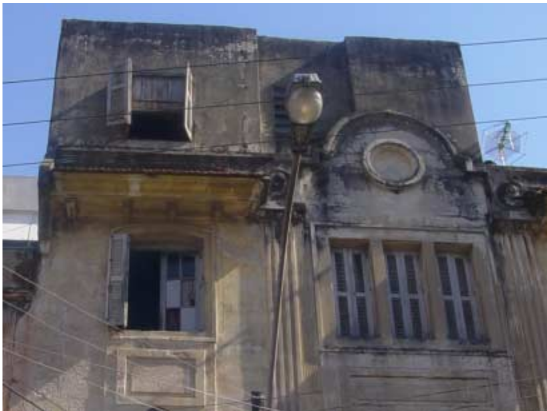
Figura 92: ampliação sobre o terceiro pavimento, manchamento superficial acentuado em relação ao restante da edificação, ausência de detalhes arquitetônicos para descolamento da lâmina de água.
