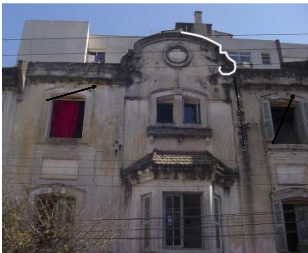
Figura 102: (a) geometria arredondada do frontão central redireciona fluxo de água para superfície da parede, ocorre manchamento superficial, lateral esquerda sofre lavagem, e erosão eólica
