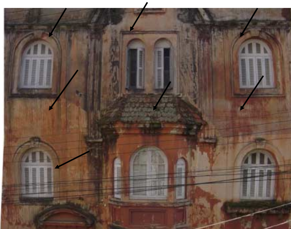
Figura 99: deposição de sujidade na moldura, diferença na geometria da moldura do segundo e terceiro pavimentos, determina maior ou menor deposição de sujidade e microorganismos.
