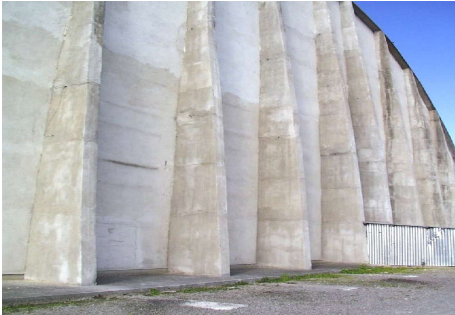
Vista das paredes e pilares de um armazém graneleiro na região de Pelotas em 1996, já apresentando manifestações patológicas.
