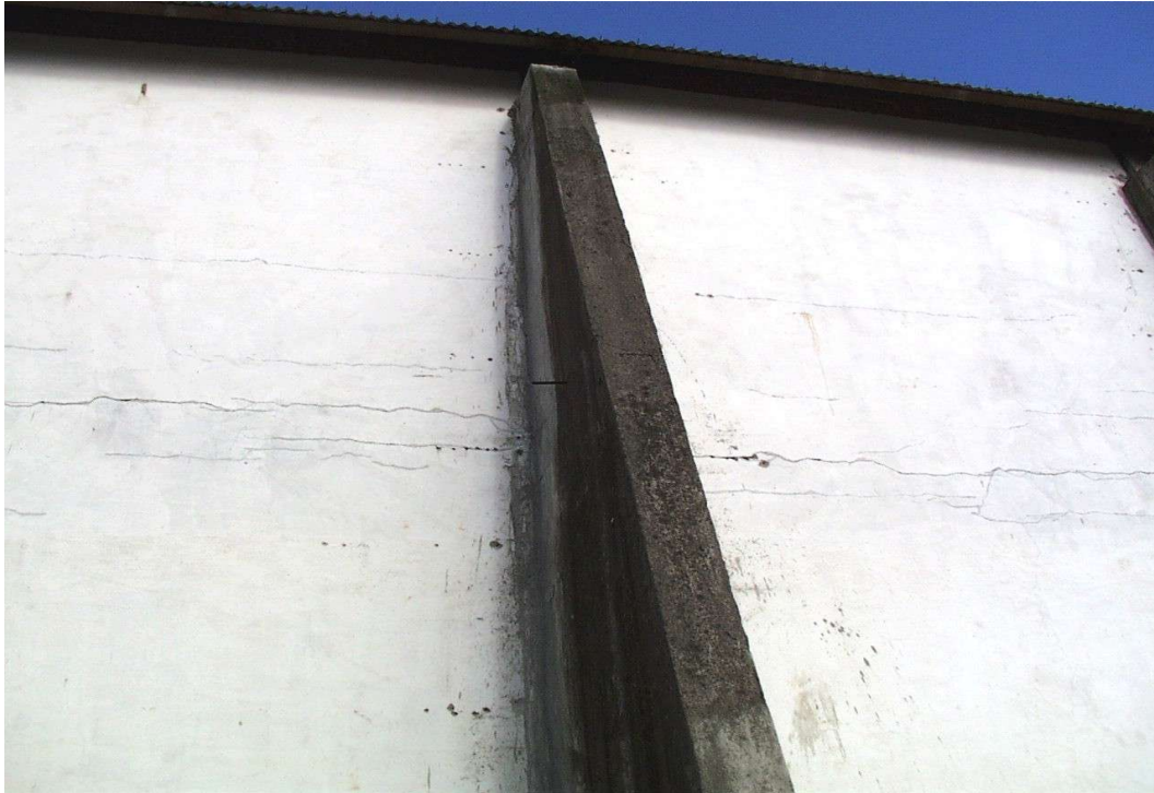
Figura 2.16 : Pilar reforçado após a ruptura e eliminação do tirante dos arcos. (Pavilhão, BR 116 km 518,5-Pelotas, 1998)
