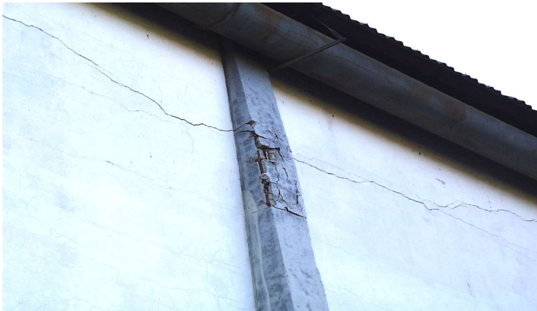
Figura 2.15 - Parede e pilar rompido por esforço passivo, gerado pelo tirante do arco.
