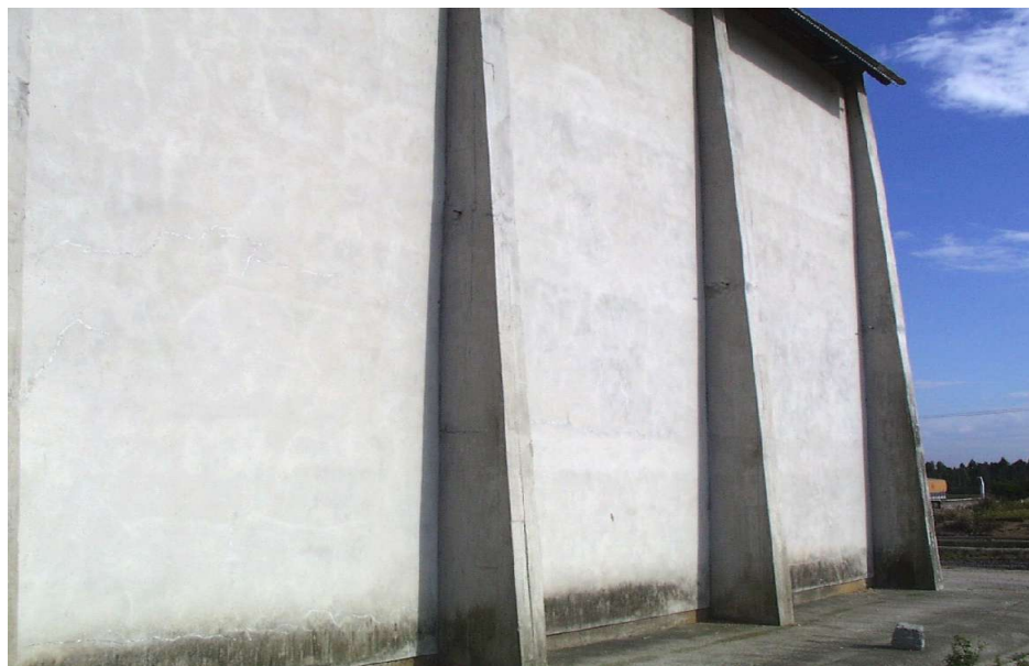
Vista das paredes e pilares de um armazém graneleiro na região de Pelotas em 1996, já apresentando manifestações patológicas.
