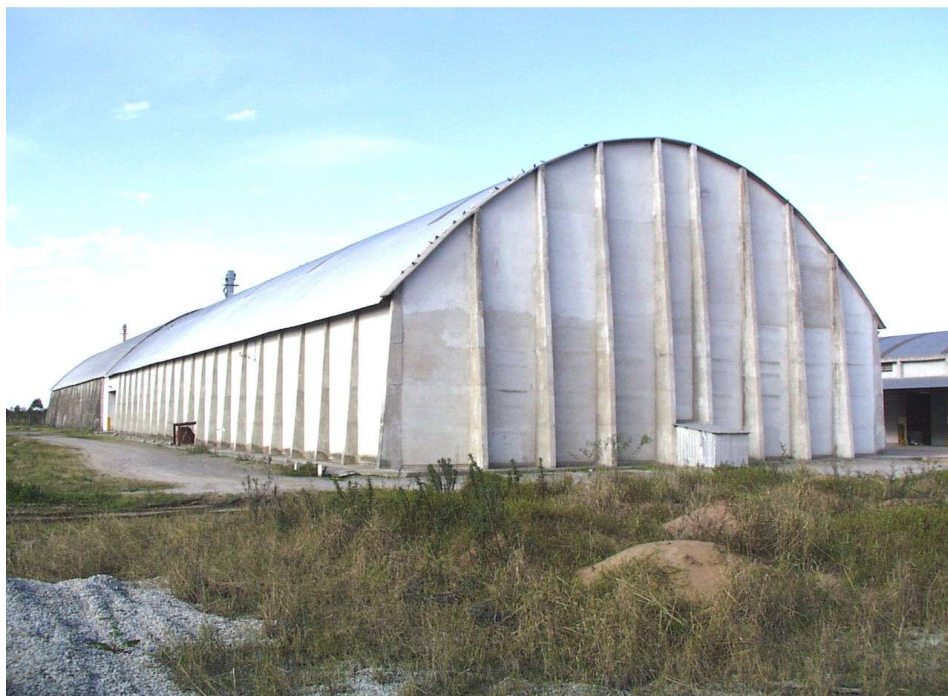
Vista geral de um armazém graneleiro na região de Pelotas em 1996, já apresentando manifestações patológicas.
