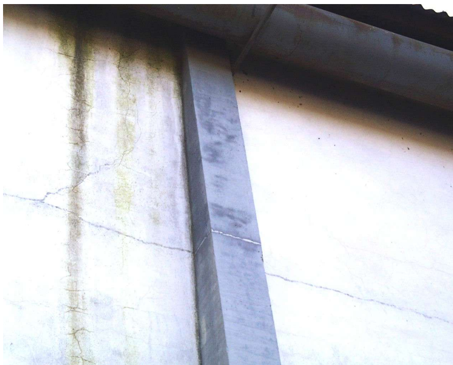
Figura 4.1 – Vista de fissuras na parede e no pilar. (Pavilhão, BR 116 km 518,5, Pelotas/RS, 1998)
