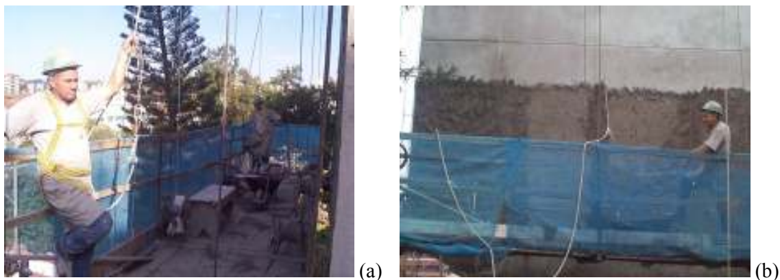
Figura 69 (a) e (b): Operários parados por falta de argamassa para execução do revestimento
