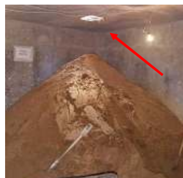
Figura 27: Detalhe da abertura da laje por onde a areia era conduzida até o subsolo
