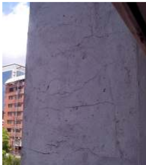
Figura 88: Fissuras na fachada do empreendimento Z
