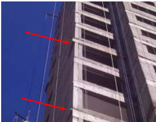
Figura 58: Vigas desalinhadas no empreendimento executado pela empresa D
