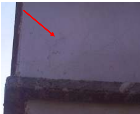
Figura 87: Fissuras em paredes externas na edificação construída pela empresa A
