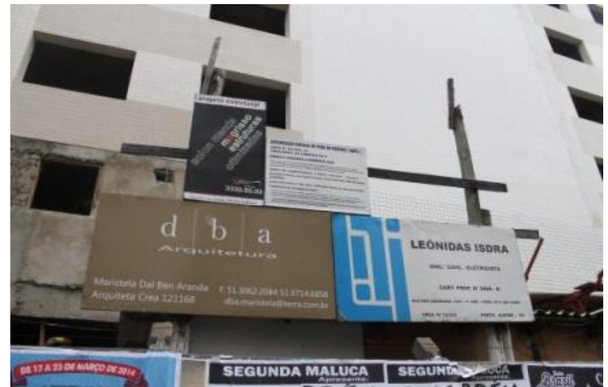
FIG. 23: Empreendimento em construção no encontro da Av. Loureiro da Silva e a Rua General Lima e Silva.
