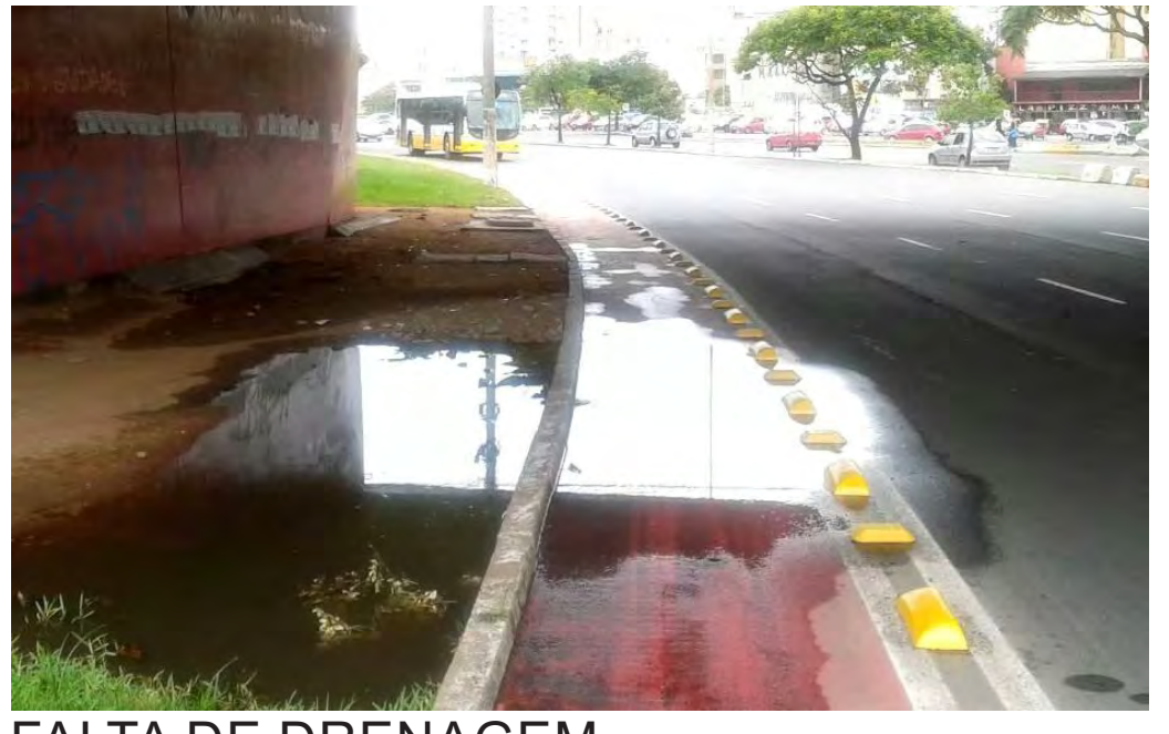
FALTA DE DRENAGEM FOTO: Avenida Loureiro da Silva
