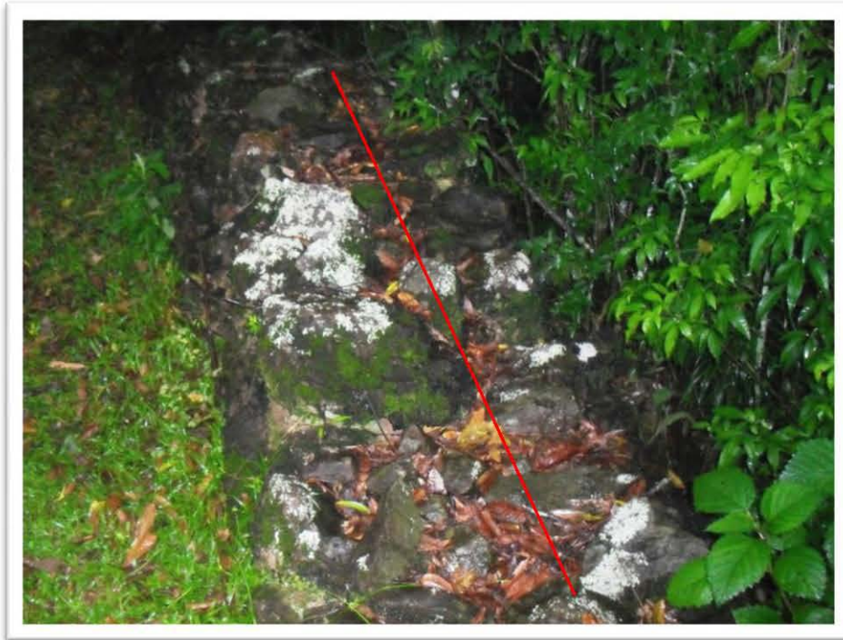
Imagem 14: rebaixamento na linha central da cerca – Arroio do Meio
