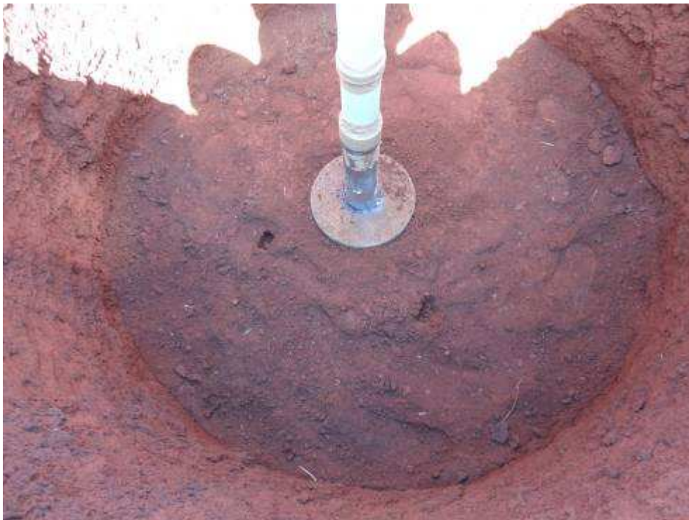
Figura 3.13: Escavação de 1,50m de diâmetro para execução do ensaio e acomodação da placa no fundo da área escavada.
