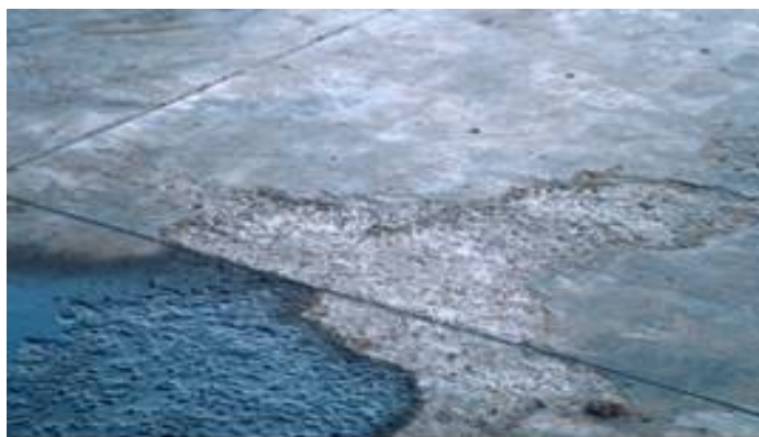
Figura 71 - Aumento de la porosidad, descamación y desagregación superficial por la acción de ciclos de hielo-deshielo (PAZINI-O'REILLY, 2003)
