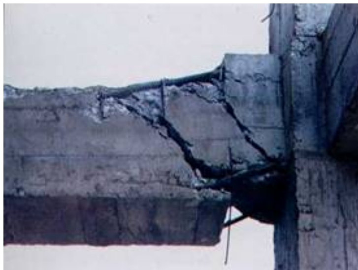
Figura 42 - Fisuración por flexión y corte (HIDALGO M, 1994 apud PAZINI-O'REILLY, 2003)
