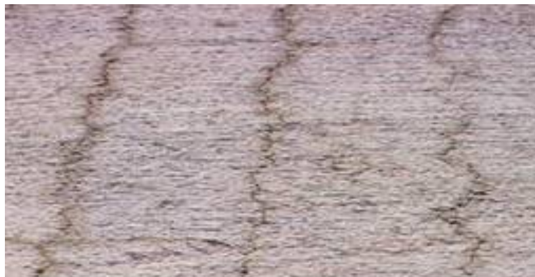
Figura 19 - Fisuración por retracción hidráulica (FIGUEIREDO-O'REILLY, 2003)
