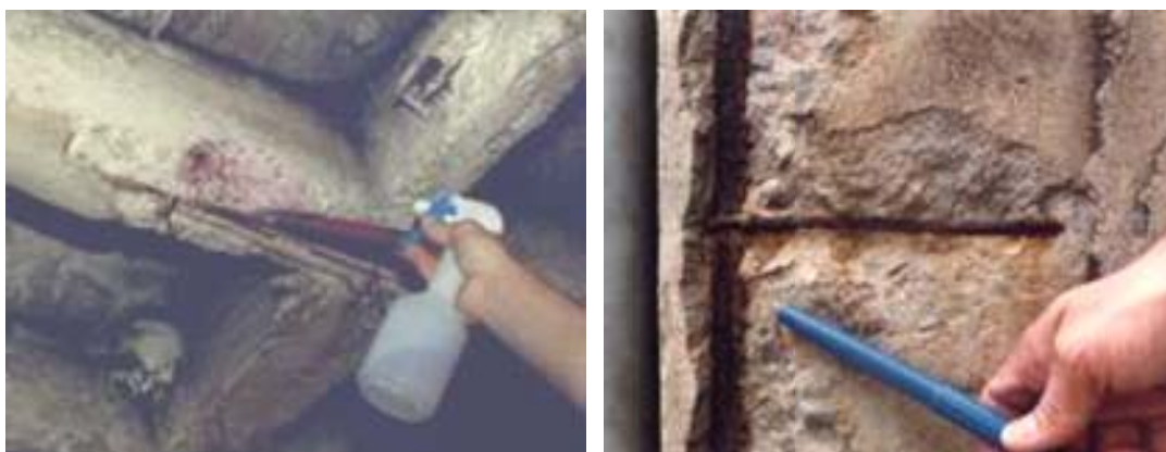
Figura 34 - Corrosión del acero de refuerzo (PAZINI-O'REILLY, 2003)
