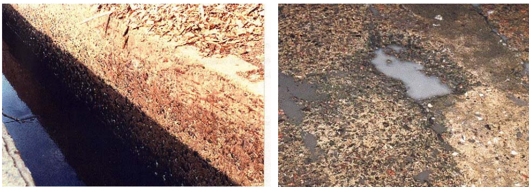
Figura 57 - Visualización del deterioro por la acción de soluciones ácidas (PAZINI-O'REILLY, 2003)
