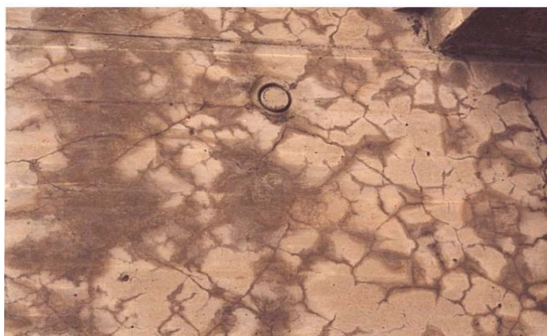
Figura 65 - Fisuración por reacción álcali-agregado (PAZINI-O'REILLY, 2003)
