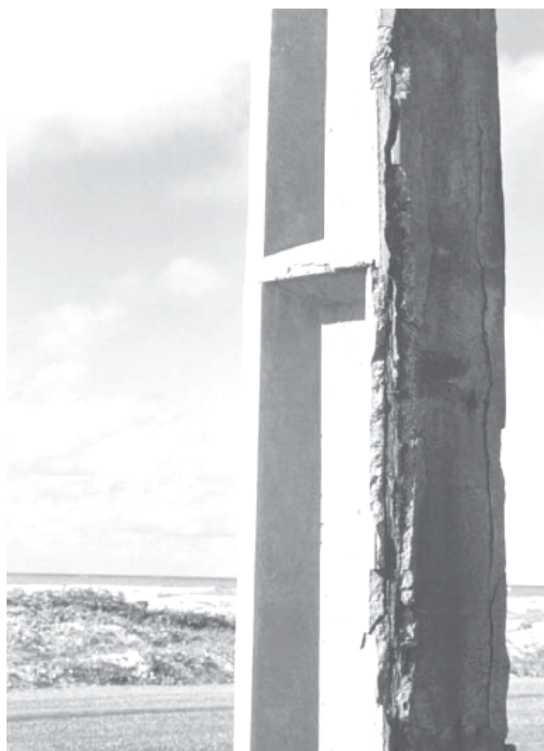
Figura 35 - Poste de hormigón con proceso de corrosión por ataque de cloruros (JOUKOSKI et al. 2004)
