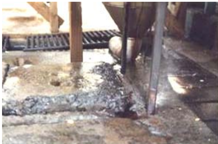
Figura 58 - Deterioro por la acción de una solución alcalina (PAZINI-O'REILLY, 2003)
