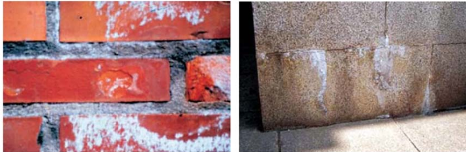
Figura 67 - Eflorescencias y cripto eflorescencias en ladrillos y piezas de revestimiento (MONJO CARRIO, 2007)
