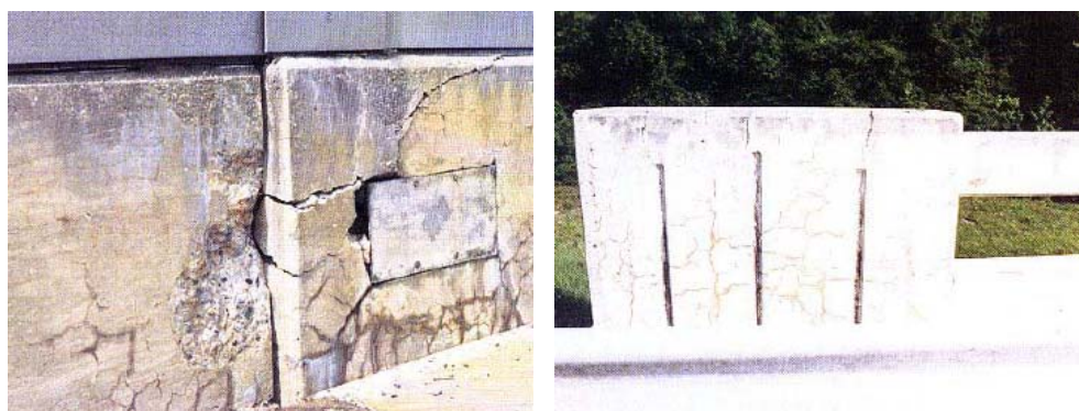
Figura 64 – Visualización de la fisuración en estructuras afectadas por reacción álcali-silíce (BECKER, 2010 d)
