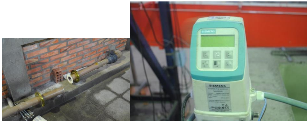
Figura 06 – Fotografias da flange e medidor de vazão. Autoria: Autor, 2012.
