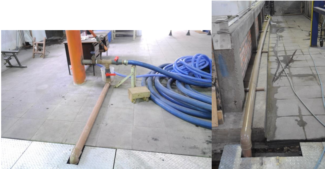
Figura 05 – Fotografias da tubulação que abastece o canal. Autoria: Autor, 2012.
