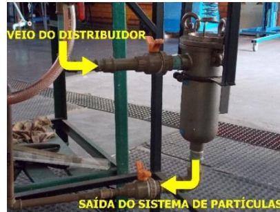
Sistema de captura de partículas acoplado à tubulação
