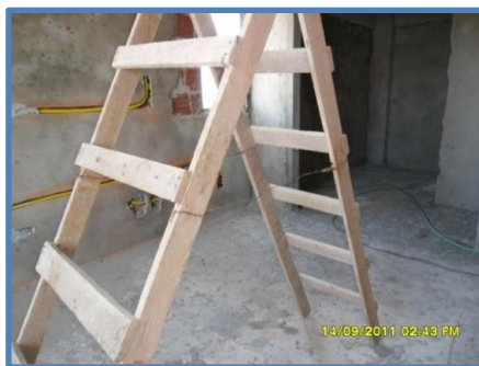
Figura 18: Escada de abrir: limitador de abertura inadequado
