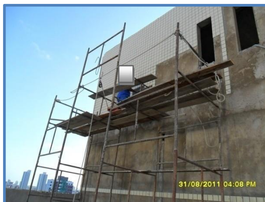
Figura 42: Andaime tubular: trabalhador sem cinto de segurança, assoalho irregular, LV amarrada no andaime
