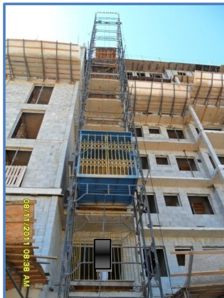
Figura 32: Revestimento externo: ausência de SGCR na periferia da laje
