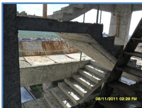
Figura 26: Plataforma de proteção: ausência de SGCR na periferia da laje e escada definitiva sem SGCR
