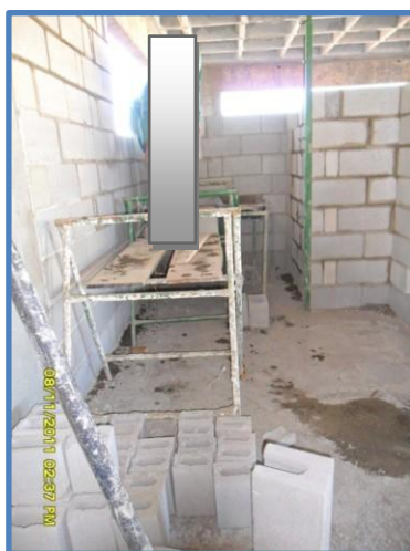
Figura 44: Levantamento de alvenaria: trabalhador sem cinto de segurança nas proximidades de abertura em janela
