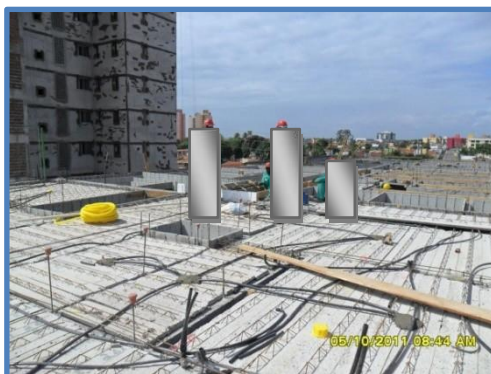
Figura 29: Confeção da laje: ausência de linha de vida no posicionamento do SGCR e centro de laje
