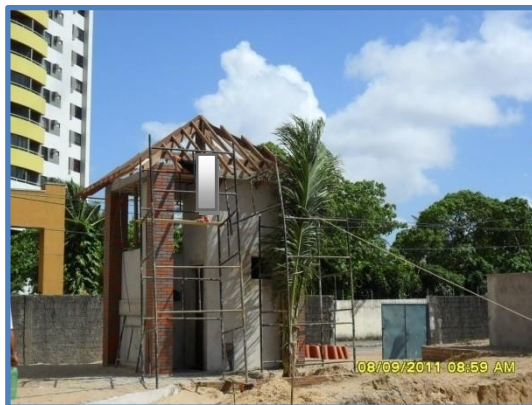
Figura 43: Confecção da estrutura do telhado: andaime irregular e ausência de cinto de segurança, LV e ancoragem
