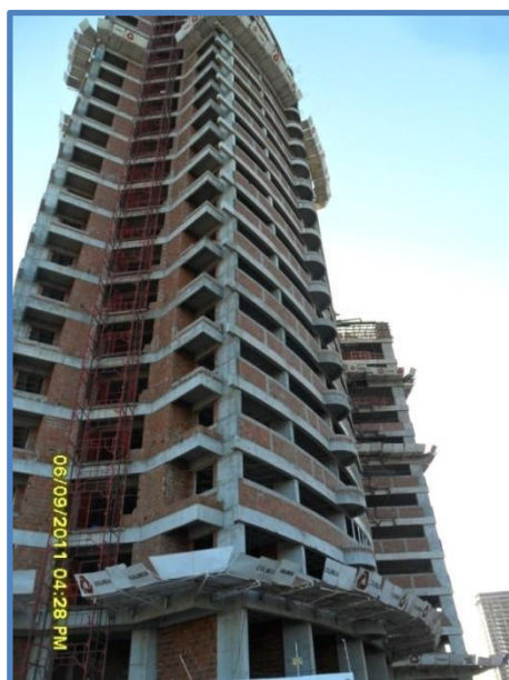
Figura 41: Paredes adjacentes a rampa do elevador: ausência de proteção contra queda de pessoas
