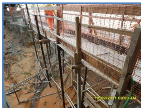
Figura 15: Passarela: ausência de projeto estrutural
