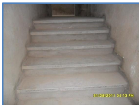
Figura 13: Escada definitiva enclausurada: ausência de corrimão
