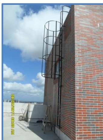
Figura 21: Escada tipo marinheiro: falta de prolongamento da gaiola protetora
