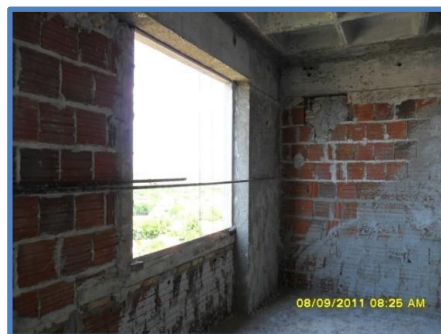
Figura 28: Abertura em paredes: guarda-corpo ineficaz
