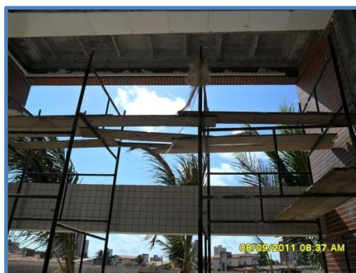
Figura 45 - Deficiência no acesso e movimentação no andaime
