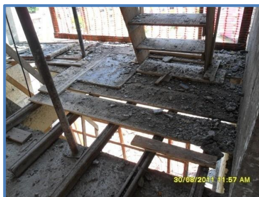
Figura 37: Poço do elevador: Utilização de assoalho para apoio da escada provisória, presença de abertura em piso e SGCR incompleto
