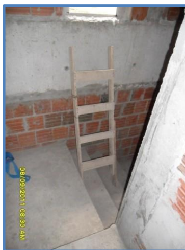
Figura 17: Escada de mão: sem fixação, dificuldade de alcance da superfície desejada
