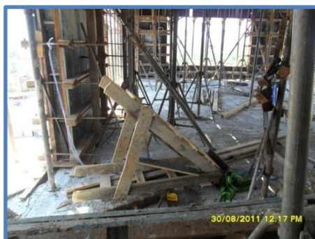
Figura 19: Escada de abrir: obstrução de passagem
