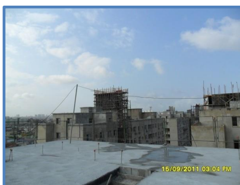
Figura 38: Abertura em piso: periferia de escada sem SGCR
