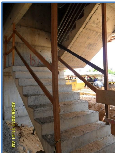
Figura 12: Escada definitiva: ausência de rodapé
