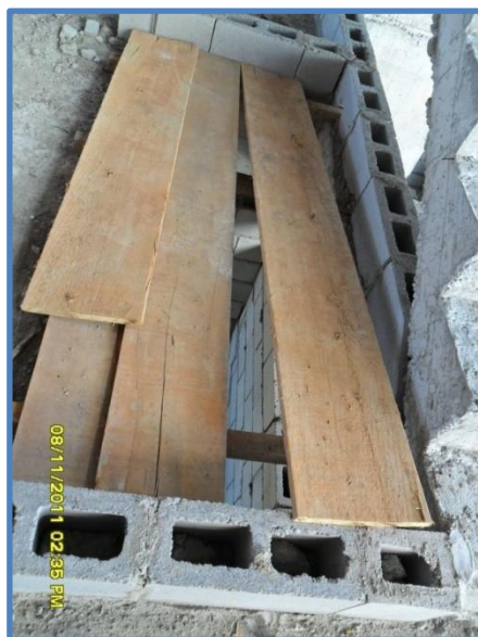
Figura 35: Abertura em piso: shaft com tábuas soltas
