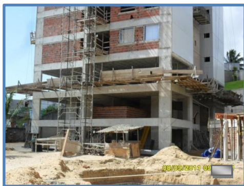
Figura 24: Laje concretada: ausência de SGCR
