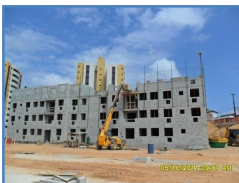
Figura 30: Levantamento da alvenaria estrutural: ausência das plataformas principal e secundária
