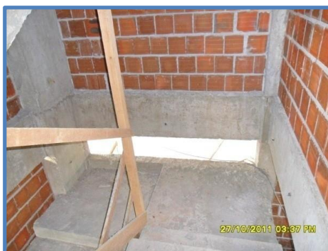
Figura 39: Abertura em parede sem proteção
