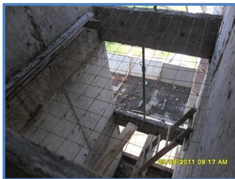
Figura 16: Escadas de mão: localização perigosa e uso de tela aramada como superfície de trabalho
