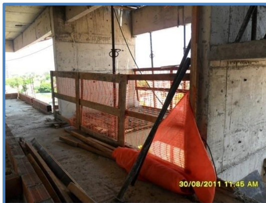
Figura 33: Caixa do elevador: abertura na tela de proteção do SGCR, ausência de SGCR na periferia da laje
