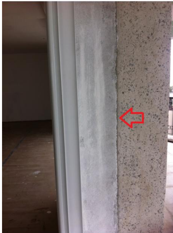
Figura 27 – Problema de acabamento na interface painel e alvenaria
