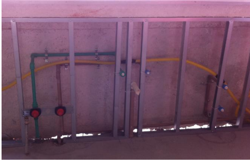
Figura 19 – Tubulações hidráulicas entre painel e parede Drywall
