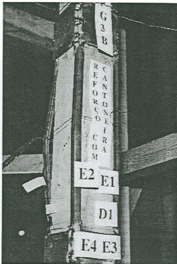
Figura 45 – Flambagem das cantoneiras do pilar reforçado com perfis metálicos.
