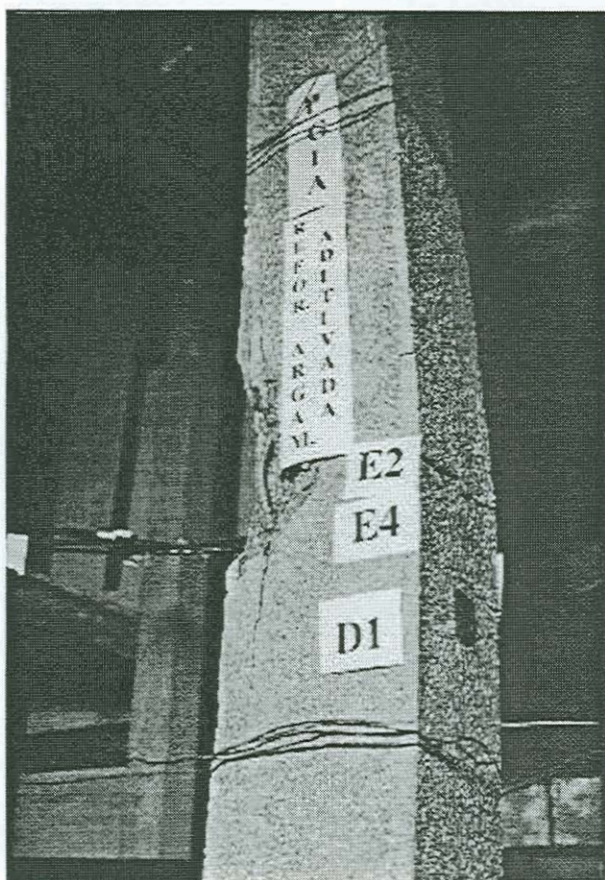
Figura 44 – Ruptura do pilar reforçado com argamassa com adição de sílica ativa.
