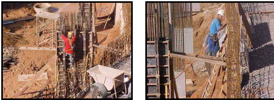
Figura 31: Dois detalhes da armação da viga de coroamento, a qual funcionou como guarda-corpo.
