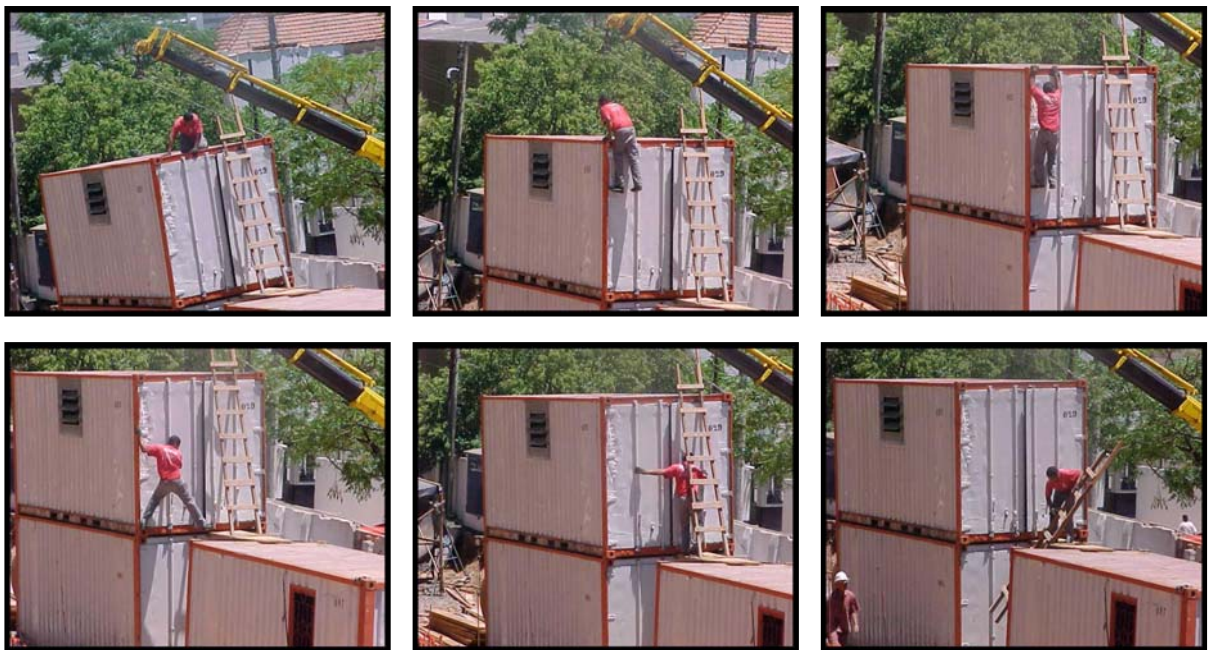
Figura 30: Pacote de apoio à produção realizado sem formalização no plano de curto prazo, com potencial para gerar acidentes.
