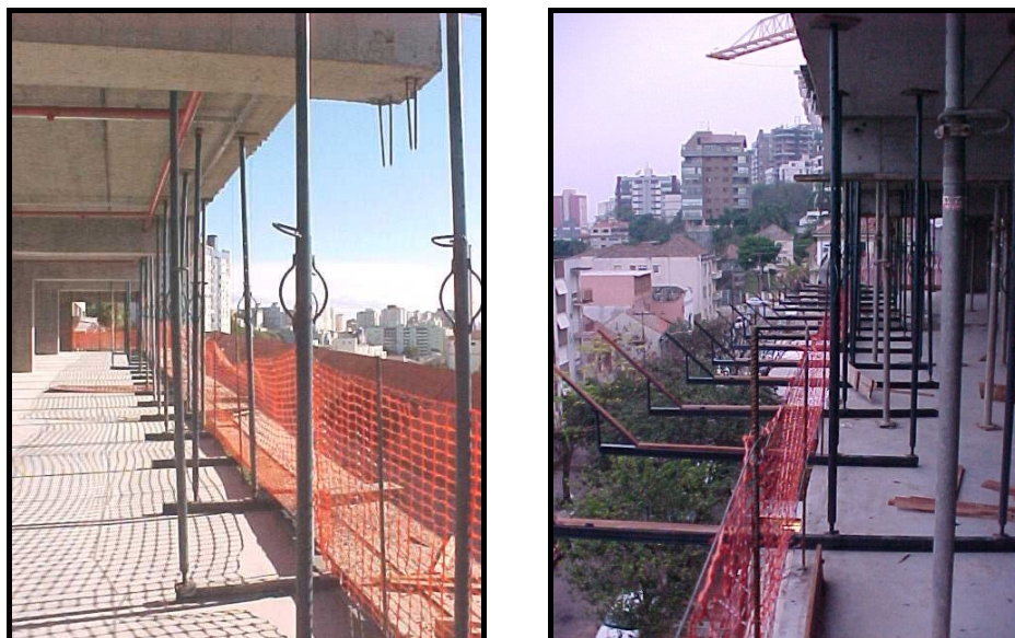
Figura 51: Exemplo da impossibilidade de atendimento à NR-18 em função da tecnologia empregada.
