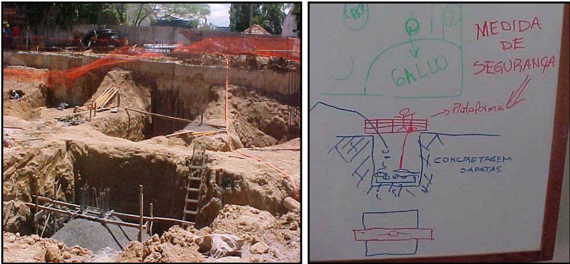
Figura 26: Falta de estudo do método executivo como gerador de falhas na análise das restrições.
