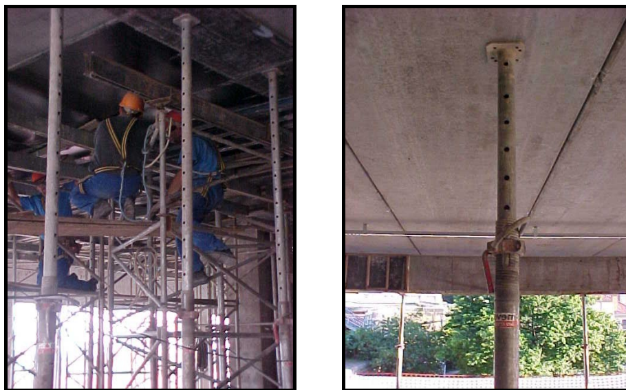
Figura 43: Detalhe da parte móvel das escoras metálicas, as quais foram agentes causadores de muitos acidentes.
