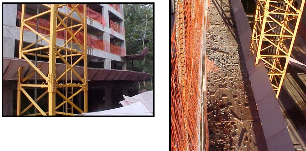
Figura 37: Interferência entre a grua e a bandeja de proteção primária, o que resultou em prejuízos à segurança e à produção.
