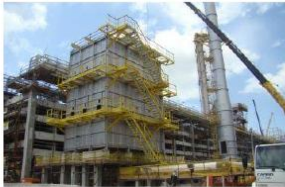
Figura 7.1 - Forno reformador da refinaria Landulpho Alves
