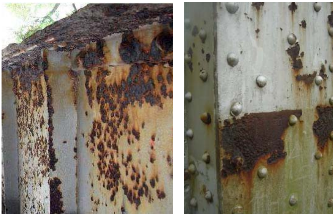
Figura 3.9: Corrosão na Ponte Hercílio Luz
