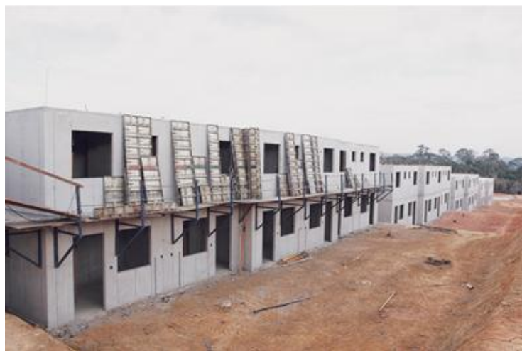
Figura 2 – Casas executadas com o sistema parede de concreto armado moldada no local
