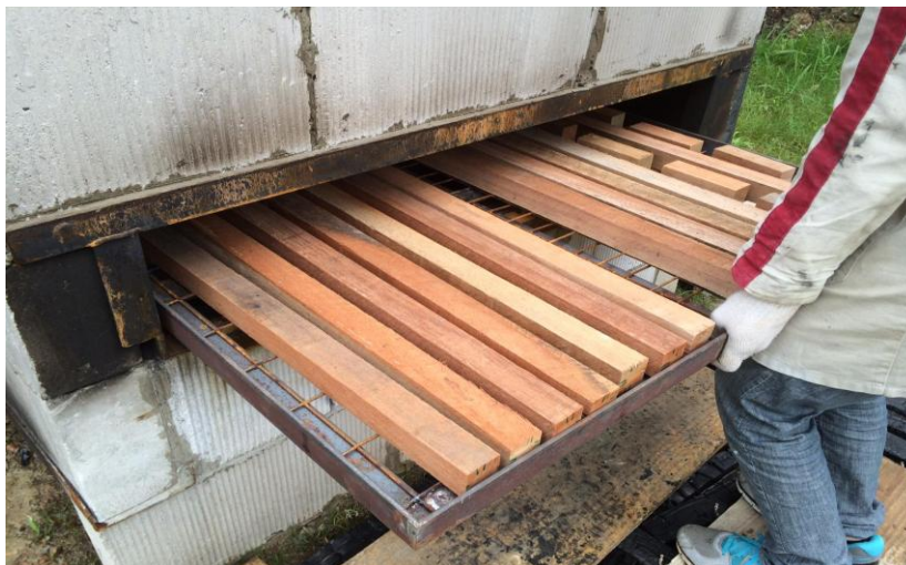
Figura 5 – Grelha de ferro fundido
