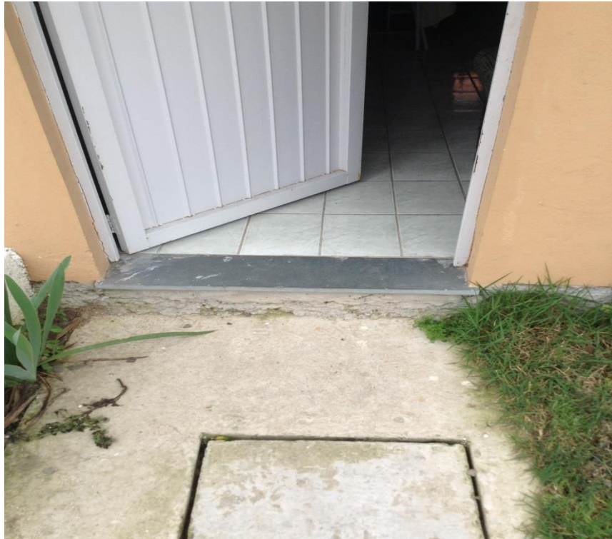
Figura 14 – Falta de acessibilidade na entrada das casas
