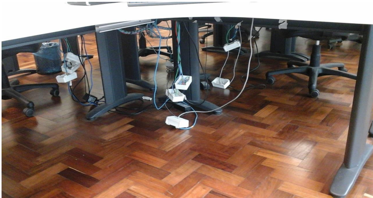
Fotografia 19 – Exposição dos fios e cabos de computadores
