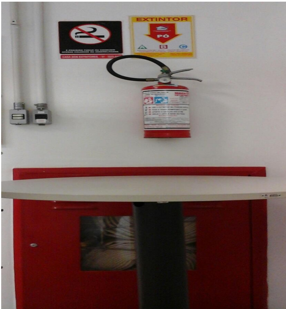
Fotografia 17 – Extintor de incêndio e hidrante na sala de convivência
