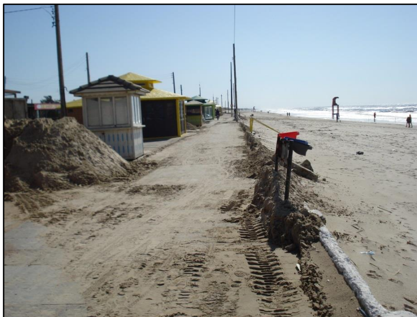
Foto 66: Ausência de dunas, areia da praia invadindo o calçadão, grande número quiosques fixos ao longo da orla, município de Imbé. Fonte: Aline Kunst, em 17/08/2013.
