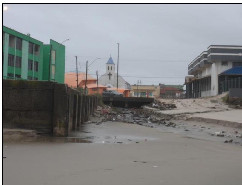
Foto 65: Final do calçadão e águas servidas lançadas ao mar sem o tratamento adequado, na área central do município de Cidreira. Fonte: Aline Kunst, em 28/06/2014.
