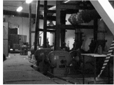
(b) Estação de recalque
