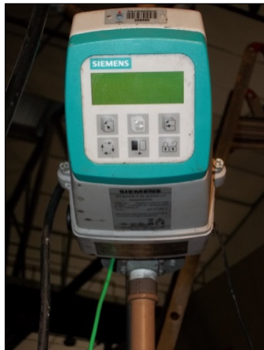
Figura 7: Medidor de vazão Siemens MAG500.
