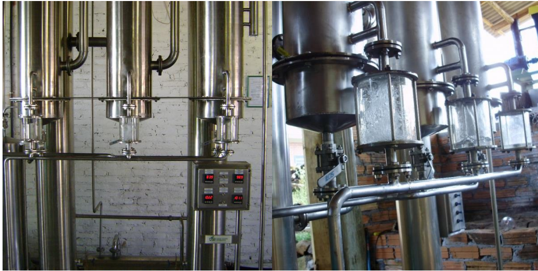
Figura B.5.2 – Sistema de monitoramento e acionamentos da usina piloto. (USI, 2013)
