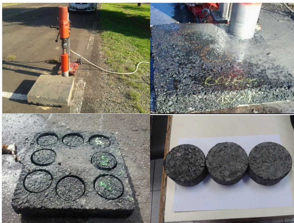
Figura 76: extração de corpos de prova cilíndricos de placas moldadas na usina de asfalto.
