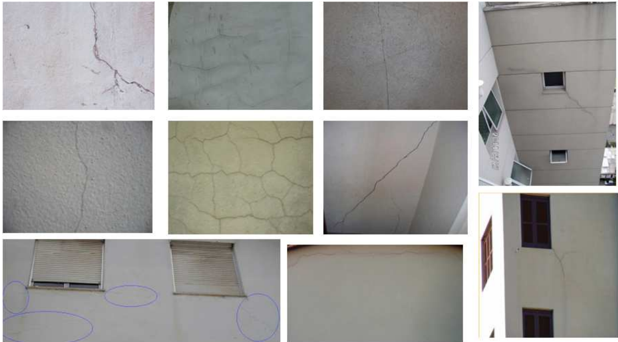
Figura 5 – Fissuras em Fachadas com Revestimento Argamassado
