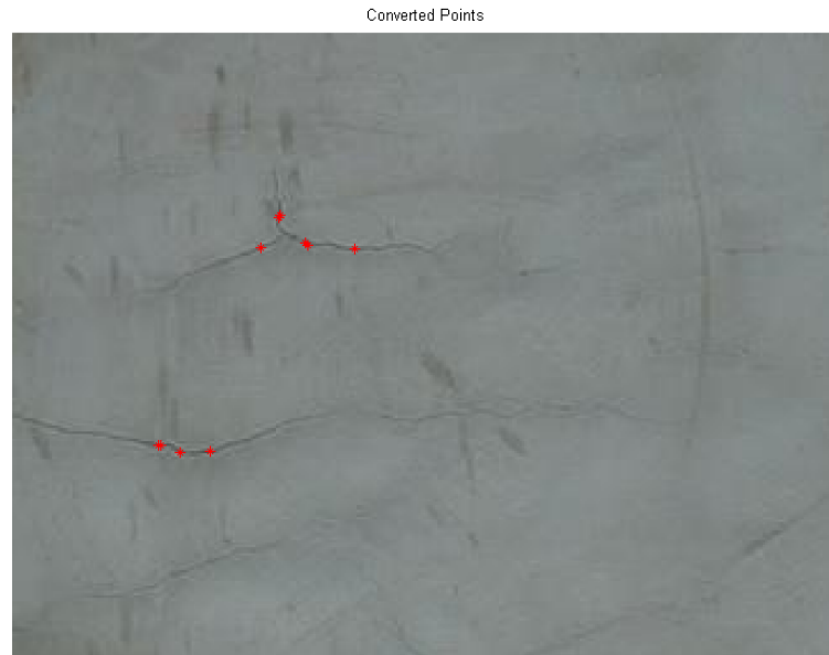
Figura 55 Detecção da fissura através do Filtro de Partículas
