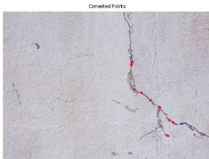
Figura 54 Detecção da fissura através do Filtro de Partículas
