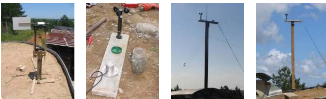
Figura 47: fotos dos sensores de radiação solar global, velocidade e direção do vento externo instalados
